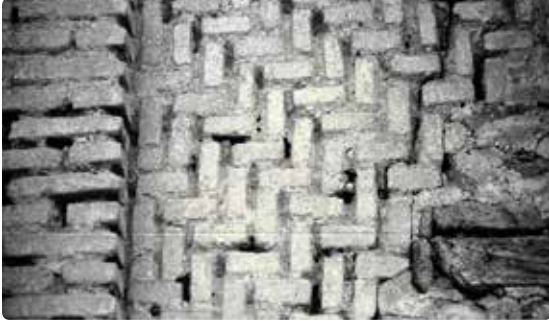
Resim 45- Mursaman Türbesi güney cephe dikdörtgen pano ayrntı
