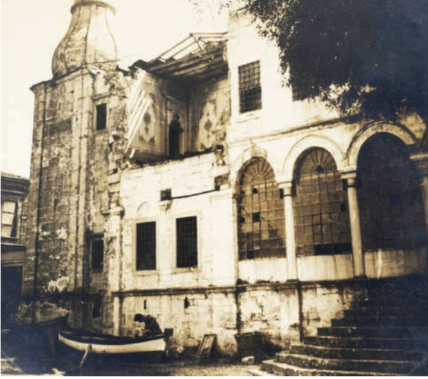
Fotoğraf 8. Rüzgardan etkilenen çatı ve minarenin görünümü (İ.A.M.E.E.E.A.1946)
