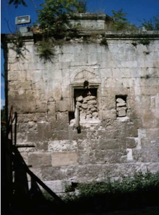
Şekil 11. Edirne Saatli Medrese Güney Cephesi/kapilarite ile tuzların, asitli yağmur sularının taştaki yarattığı yüzeysel erozyon tahrifatı. Çatıda yüksek bitki tahrifatı (Dal, 2005)
