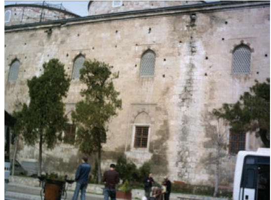
Şekil 9. Edirne Eski Cami güney cephesinde asitli yağmur sularının ve tapraktaki tuzların kapilarite ile cephede yarattığı tahribat (Dal, 2005).
