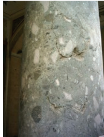
Şekil 2. Edirne Selimiye Camii Giriş sütununda kullanılan Hereke pudinginde oluşan büyük parça kayıpları ve çatlaklar şeklinde görülen bozulmalar.
