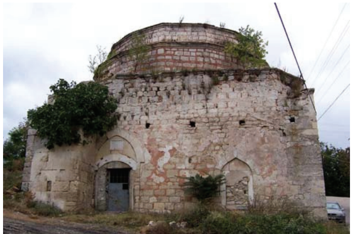
Şekil 18. Kırklareli Vize Şerbetdar Hasan Bey Camii'nde yüksek bitki tahribatı (incir ağacı) (Dal, 2008)
