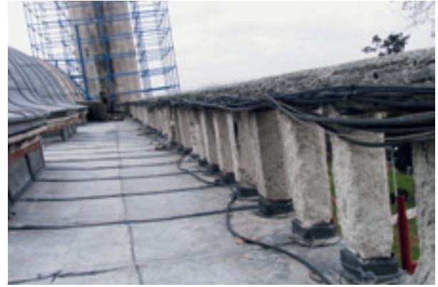
Fotoğraf 8 Cami doğu cephesi yoğun karbon birikimi,
