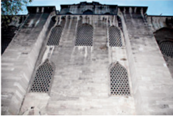
Fotoğraf 5 Cami güney cephesi yoğun karbon birikimi,
