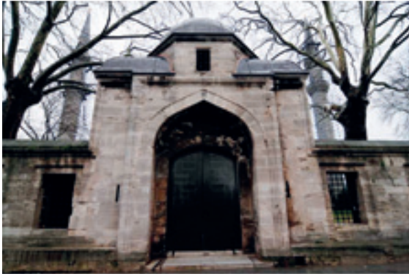
Fotoğraf 7 Cami dış avlu duvarları ve giriş kapıları karbon birikimi,
