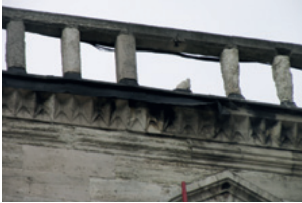
Fotoğraf 9 Cami dış avlu duvarları ve giriş kapıları karbon birikimi,
