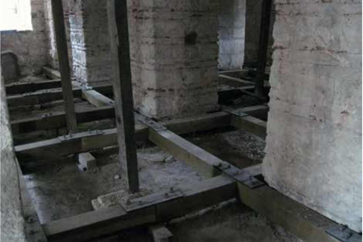
Fotoğraf 83. Bodrum katta yenilenen ahşap hatil sistemi
