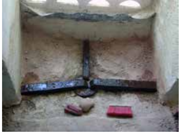
Fotoğraf 45. İçlik dışlık arası tabanında demir hatıl sistemi
