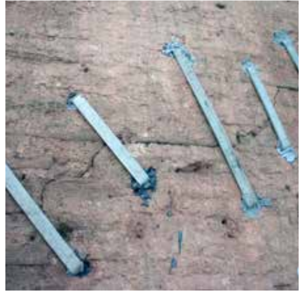
Fotoğraf 26. Paslanmaz çelik kenetlerin çatlak hattı boyunca dizilimi
