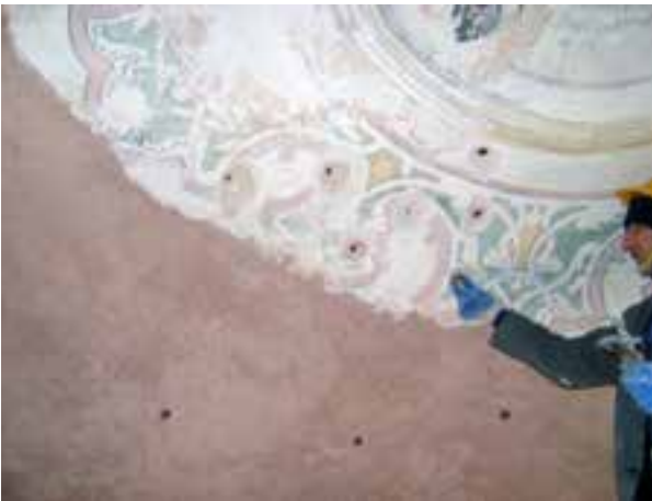
Fotoğraf 27. Kurşun örtü altında zamanla korozyona uğramış çivilerin sökülmesi
