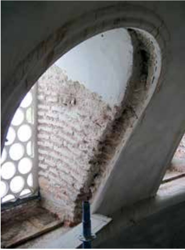
Fotoğraf 48. İşlevini yitirmiş ahşap hatıl sistemi
