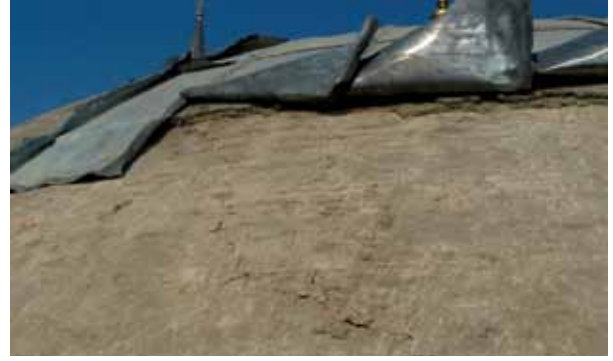
Fotoğraf 5. Kubbede oluşan çatlaklar.
