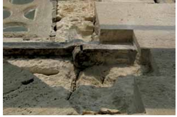
Fotoğraf 4. Dövme demir gergi hasarı.
