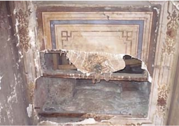
Resim, 50- Mevcut asma tavanın kaldırılması sonucu ortaya çıkmış tuvalet tavanı kalem işleri
