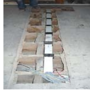
Resim, 77- Döşeme içinden geçirilmiş elektrik hattı
