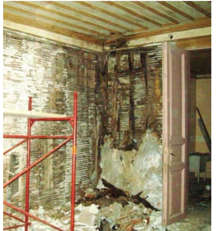
Resim,20- Yapı karkasında oluşan çürümeler
