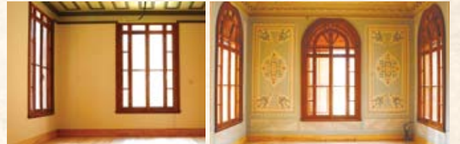
Resim,40- Üst ve alt kat pencereleri özgün detayına uygun olarak yeniden yapıldı.
