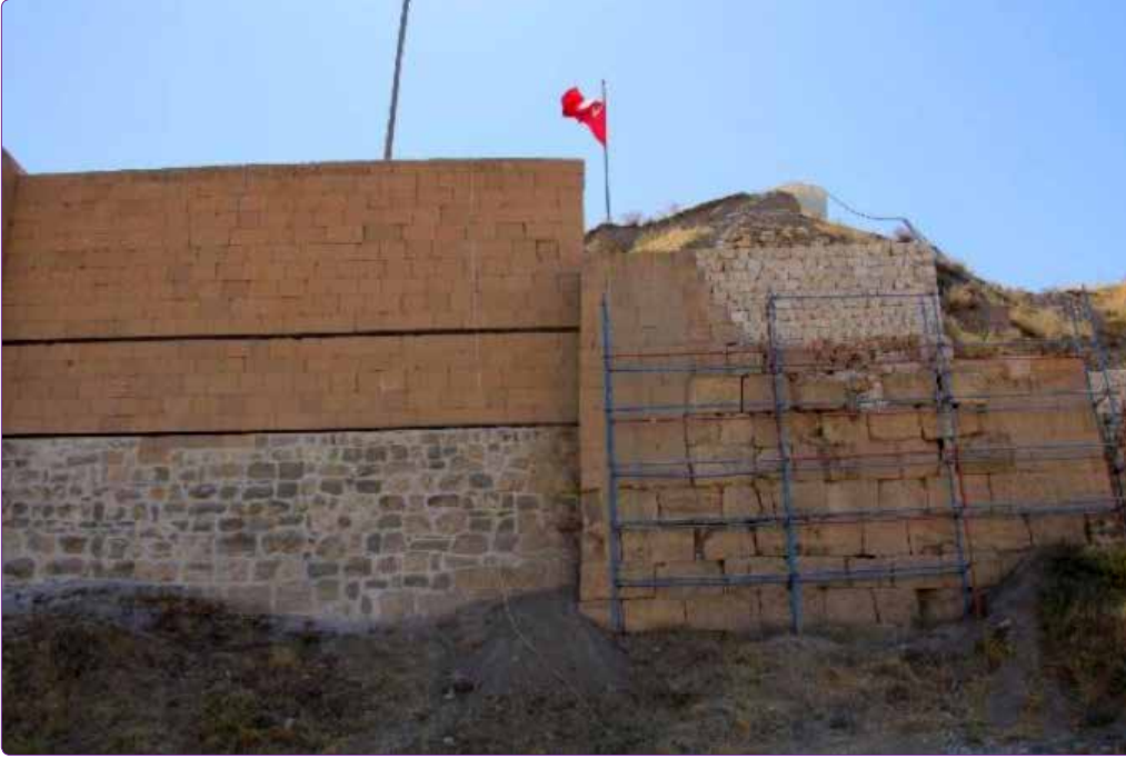
Şekil 19. Malzeme ve işçilik bakımından sorunlu rekonstrüksiyon detayı.
