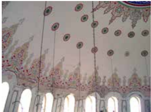
Fotoğraf 2 Merkezi Kubbe, Hasarlı Kubbe Yüzeyi
