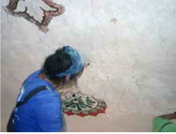
Fotoğraf 8 Raspa Sonrası Kılcal Çatlaklar
