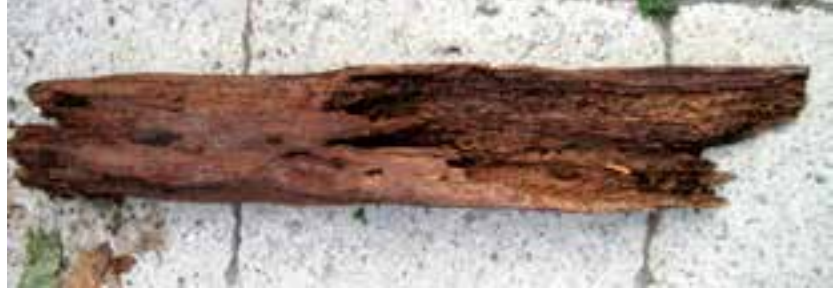
Fotoğraf 31-32. Ahşap hatıl boşluğu ve içinden çıkan çürümüş ahşap hatıl.
