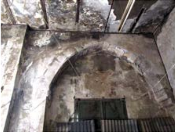
Şekil 20. Kuzey revağı örten demir kirişler ve beton plaktan oluşan sistem, 2011 Fig 20. The roofing system of iron beams and concrete covering the northern arcade, 2011
