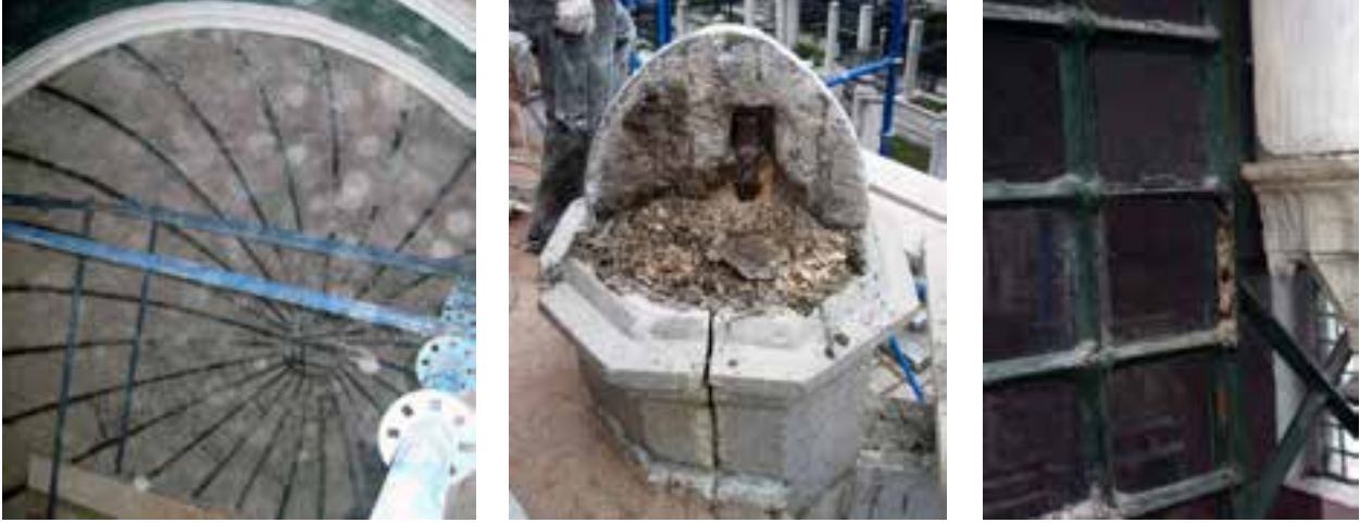
Fotoğraf 20-21-22 Korozyon tespit edilen metal elemanlar
