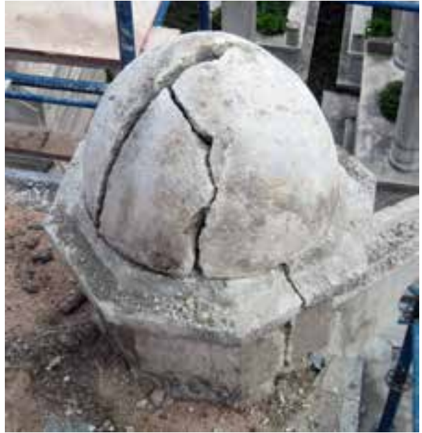
Fotoğraf 14 Ağırılık kulesindeki çatlak
