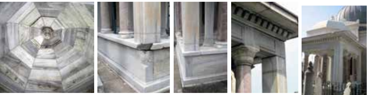
Fotoğraf 6-7-8-9-10 Hasarlı olan mermer yüzeyler ve restorasyon sonrası
