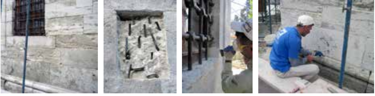
Fotoğraf 8-9-10-11 Taş yüzeylerde görülen bozulmalar ve onarım çalışmaları
