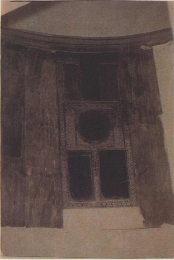
Resim 3: Trabzon Fatih Camii'nde bulunan diğer mermer ve mozaik ile kaplı duvarın kirli hali.
