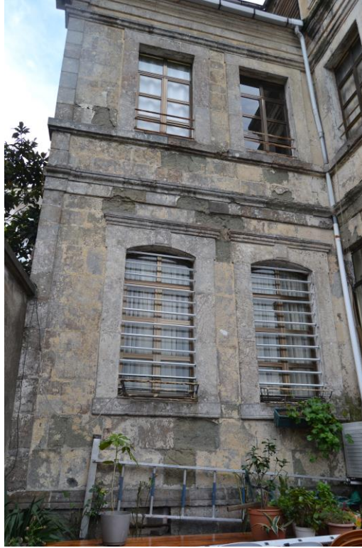
Şekil 4.20. Ana yapı kuzey cephe- taş yüzeylerde kirlenme, yüzey erozyonu, sıvalı yüzeyler, muhdes malzemeler (2019)
