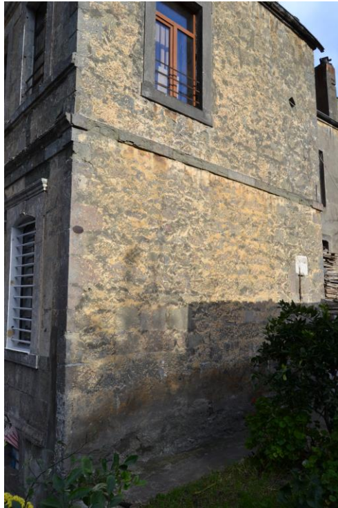
Şekil 4.22. Ana yapı doğu cephesi- yüzeyde kirlenme, nemlenme sonucu bodrum kat hizasında malzemede renk değişimi, yüzey erozyonu, muhdes elemanlar (2019)
