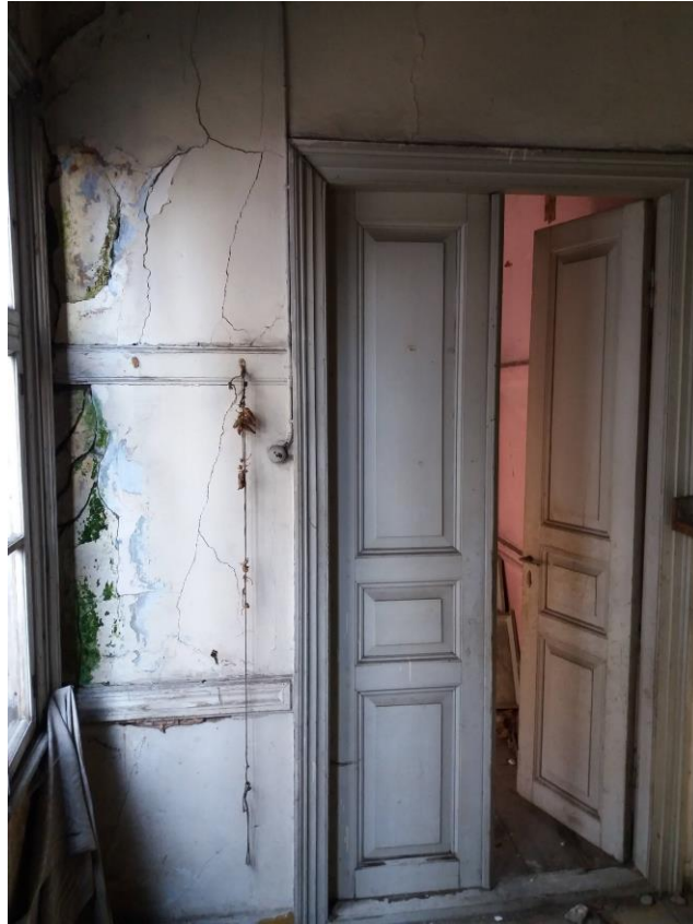
Şekil 4.27. Ek bina 1-01 numaralı hol – yüzeysel çatlaklar, küflenme, yosunlanma, yüzey kabarması, nemlenme, boya tabakasında aşınma (2019)
