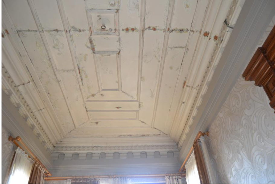
Şekil 4.24. Ana yapı birinci kat hol tavan – boya tabakasının aşınması (2019)
