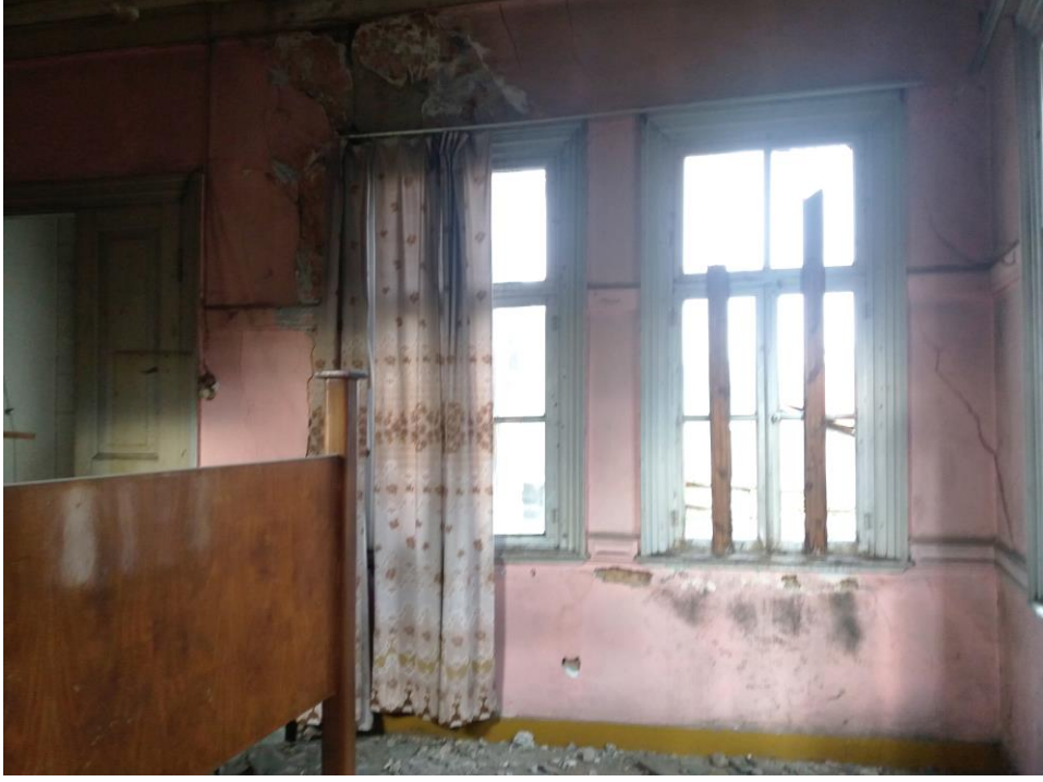
Şekil 4.26. Ek bina 1-03 numaralı oda – malzeme kaybı, yüzeysel çatlaklar, yüzey kabarması, nemlenme (2019)
