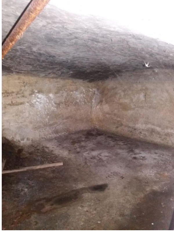
Şekil 4.23. Ana yapı bodrum kat – nemlenme, yüzey kabarması (2019)
