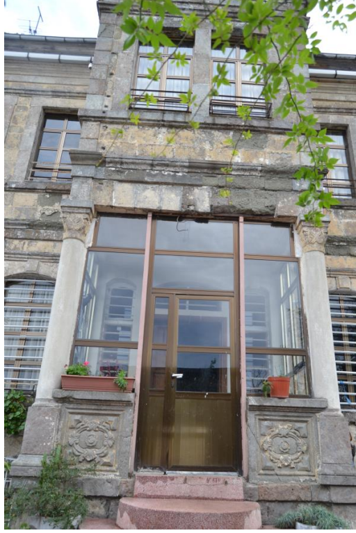
Şekil 4.21. Malzemede meydana gelen yüzeyel çatlaklar, malzeme kayıpları, yüzey erozyonu ve taş yüzeylerde meydana gelen kirlenme, metal elemanlarda korozyon (2019)
