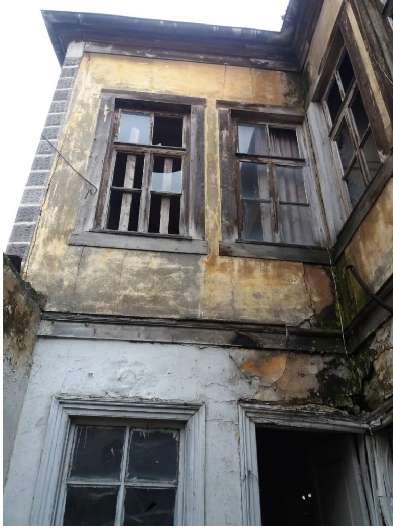
Şekil 4.25. Ek bina batı cephesi- Malzeme kaybı, çürüme, otsu biyolojik oluşumlar, nemlenme (2019)
