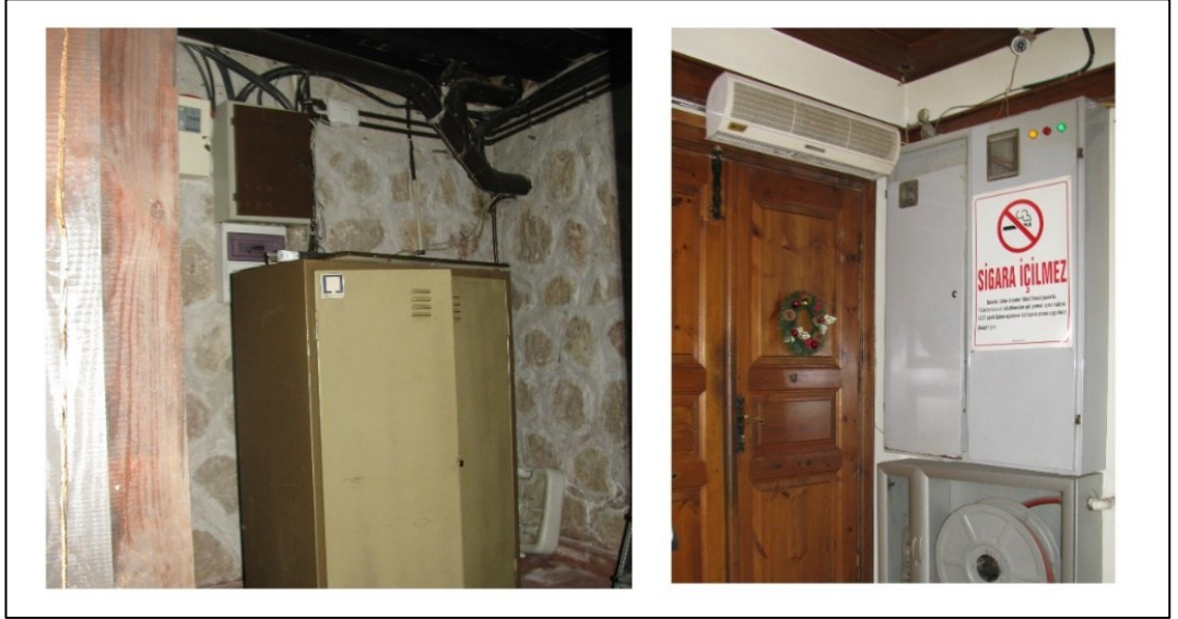
Resim 3.11 Geleneksel yapılarda elektrik kutuları. 184
