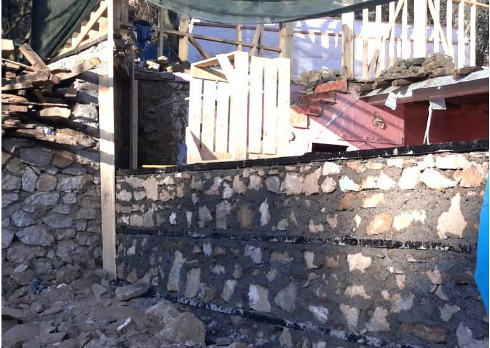
Resim 42 Taş duvar arasında ahşap hatıllar
