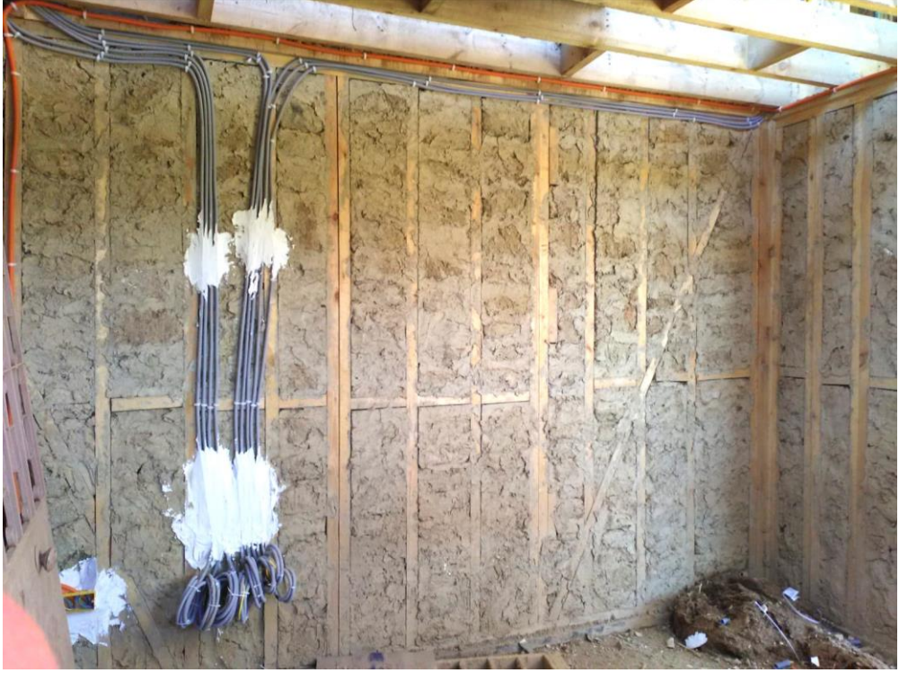
Resim 106 Duvardan ve tavandan geçen elektrik hatları
