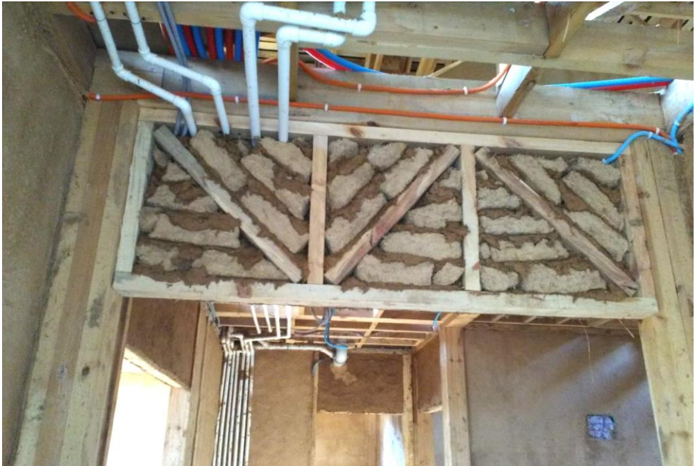
Resim 102 Tesisatların geçtiği hat
