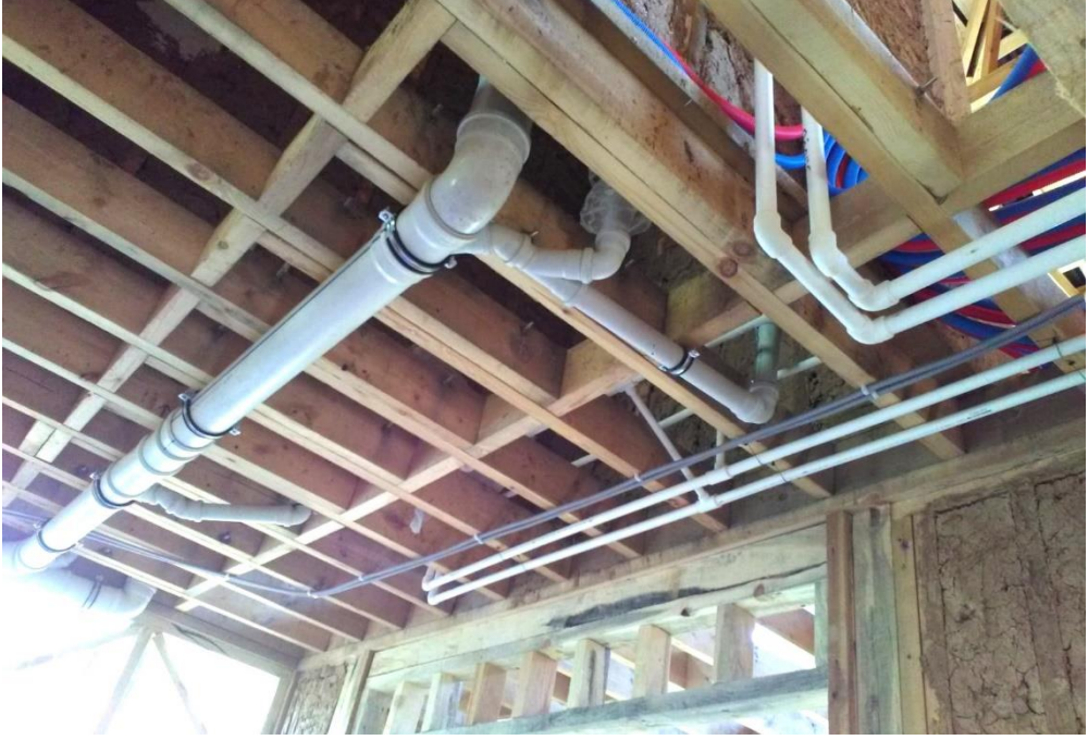
Resim 103 Tesisatların geçtiği hat
