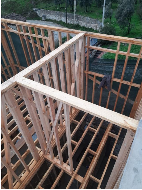
Resim 84 Ahşap döşeme merteklerinin oturduğu tabanlar
