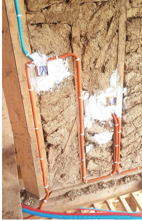
Resim 107 Duvardan geçen elektrik hatları
