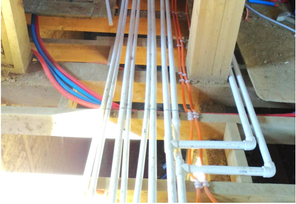
Resim 101. Temiz su sıcak ve soğuk hat boruları
