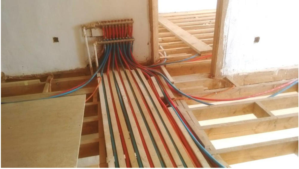
Resim 108 Döşemeden geçen ısıtma sistemi boruları ile onları gizleyen çıtalar ve kollektör
