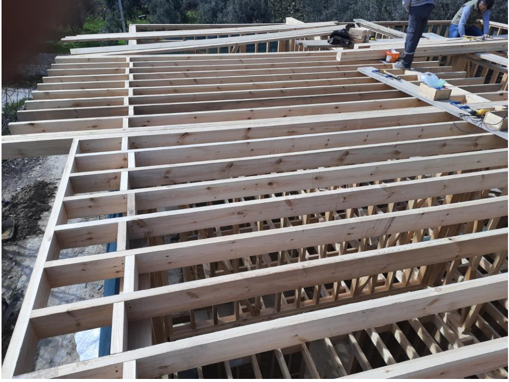
Resim 83 Ahşap döşeme merteklerinin oturduğu tabanlar
