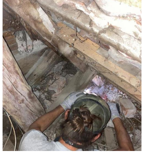
Şekil 2.8 Çatıda mantar tespiti (Url-40)
