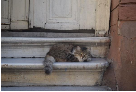
Şekil 4.41 1019 ada 20 parseldeki konutun mermer merdiven basamaklarında ve ahşap kapısında aşınma, Yapı No: 26 (Güzelaydın, 2021)
