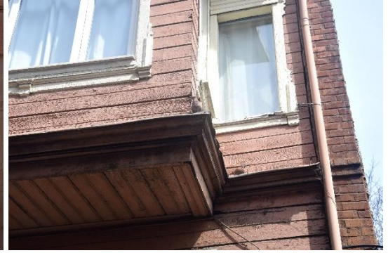
Şekil 4.42 1019 ada 20 parseldeki konutun ahşap cephe kaplamasında zamana bağlı eskime, Yapı No: 26 (Güzelaydın, 2022)
