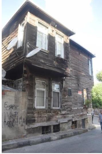
Şekil 4.45 2197 ada 17 parseldeki yapıda bakımsızlık nedeniyle cephe kaplamasında bozulma, Yapı No: 01 (Güzelaydın, 2021)
