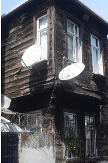
Şekil 4.66 2197 ada 17 parseldeki konutun cephesinde çanak antenler, Yapı No: 1 (Güzelaydın, 2022)
