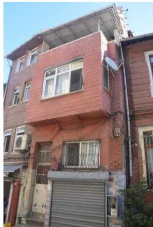
Şekil 4.62 1019 ada 21 parseldeki konutun cephesinde niteliksiz müdahaleler, Yapı No: 24 (Güzelaydın, 2022)
