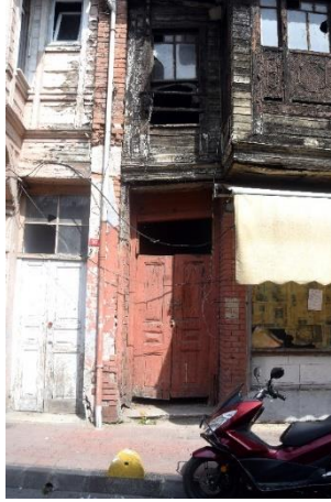
Şekil 4.39 1019 ada 17 parseldeki konutta terk edilme kaynaklı hasarlar, Yapı No: 31 (Güzelaydın, 2022)
