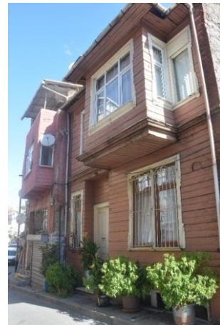
Şekil 4.63 1019 ada 20 parseldeki konutun cephesinde niteliksiz müdahaleler, Yapı No: 26 (Güzelaydın, 2022)
