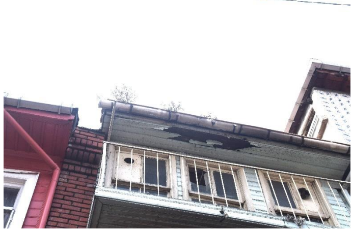
Şekil 4.44 2186 ada 26 parseldeki konutun çatı oluklarında bitki oluşumu, Yapı No: 19 (Güzelaydın, 2022)
