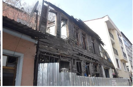
Şekil 4.38 2188 ada 59 parseldeki konutta
