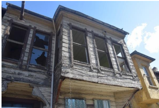
Şekil 4.40 1019 ada 16 parseldeki konutta vandalizm kaynaklı hasar oluşumu, Yapı No: 28 (Güzelaydın, 2021)
