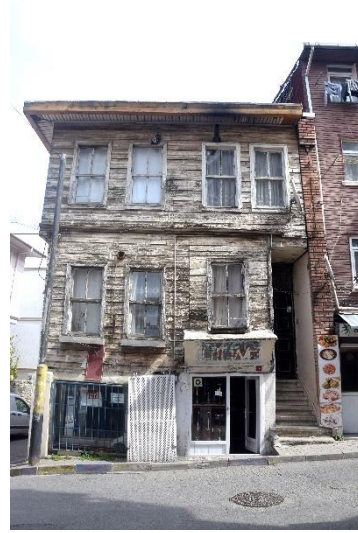
Şekil 4.46 1019 ada 23 parseldeki yapıda bakımsızlık nedeniyle cephe kaplamasında bozulma, Yapı No: 22 (Güzelaydın, 2022)
