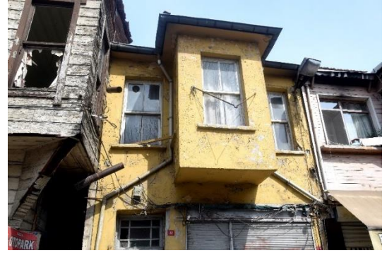
Şekil 4.65 1019 ada 15 parseldeki konutun cephesinde tesisat kabloları ve yağmur suyu iniş boruları, Yapı No: 29 (Güzelaydın, 2022)
