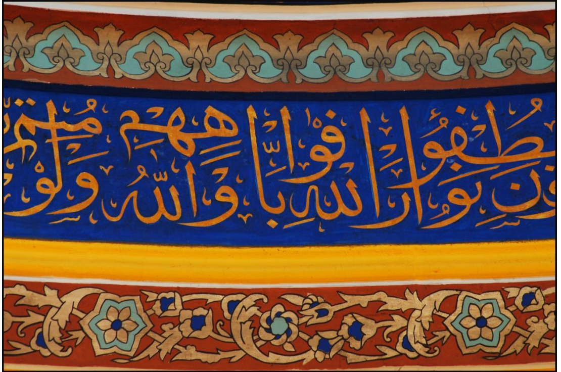
Resim 128: Kubbe Kasnağındaki Kuşak Yazısı Restorasyon Tahribatından Detay (F. M. Yılmaz)
