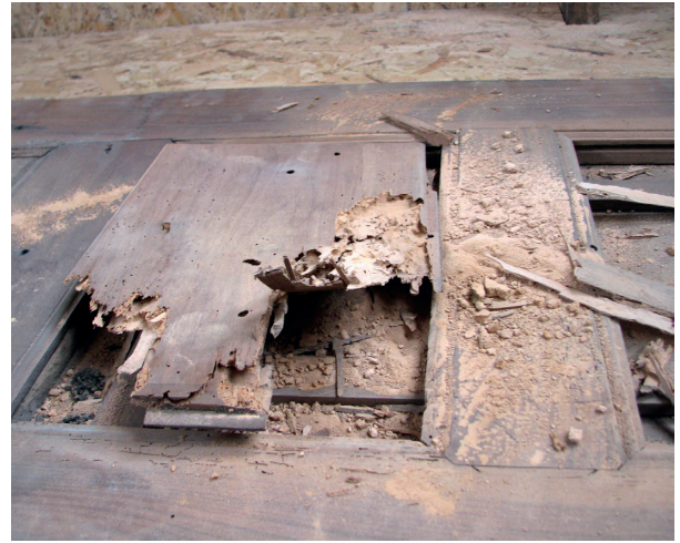
Fotoğraf 9. Ahşaptaki mantarlaşma, çürüme ve böceklenmeye örnek
