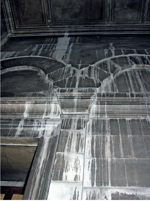
Fotoğraf 4. Duvar yüzeyindeki tuzlanma
