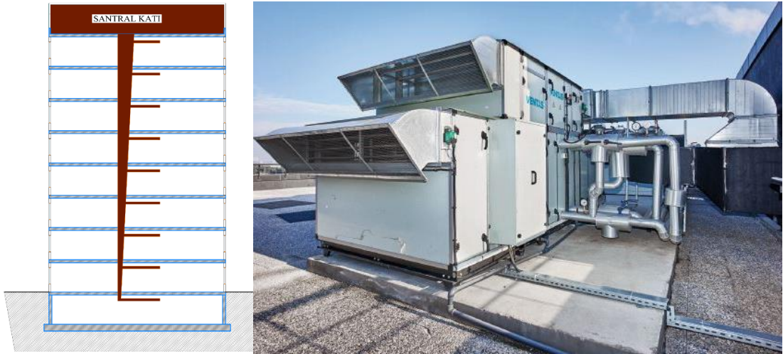
Şekil 4.3: İklimsel Konfor Santralinin Çatı Katta Bulunma Durumu (Maktes, 2017).
