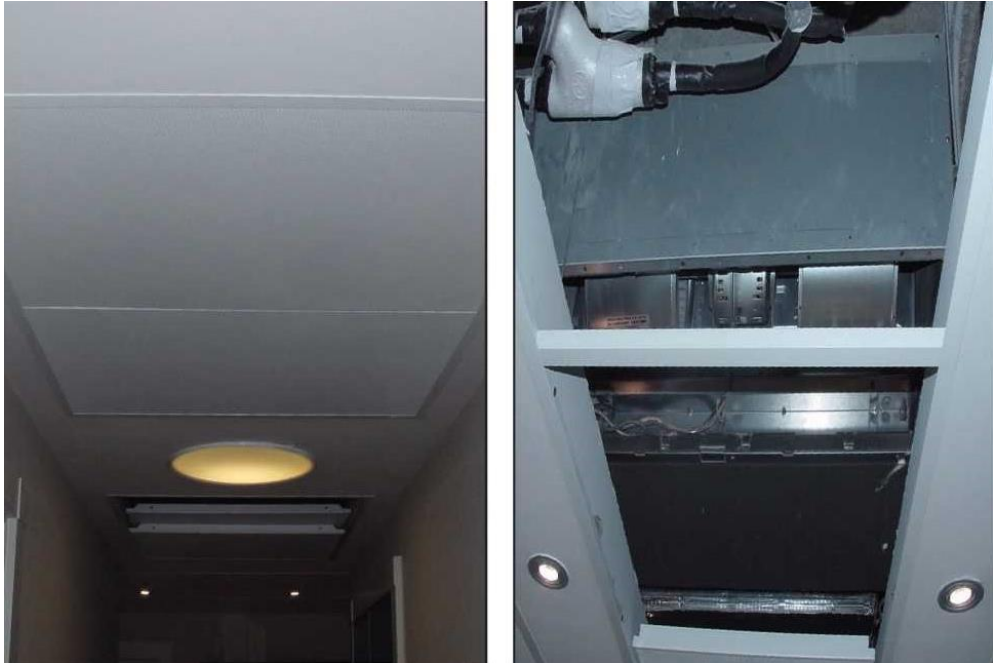
Şekil 4.16: Gizli Tavan Ünitelerinin Görseli Metrocity Rezidans(Anonim, 2007).
