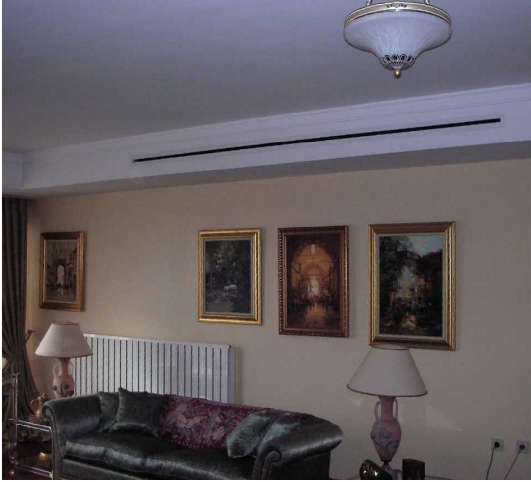
Şekil 4.13: Hava Kanallı Sistemin İç Mimariye Olan Etkisi Şekil 4.12’de Gösterilen Mimari Plandaki Salon Uygulaması Slot Difüzör Trio Konutları (Anonim, 2007).
