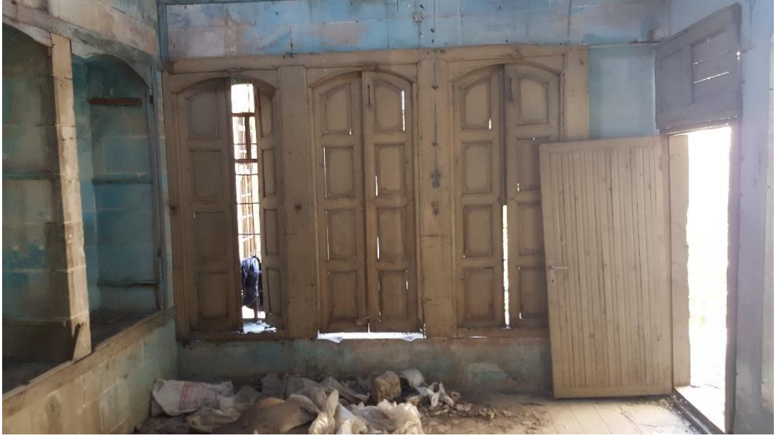
Şekil 0.35. 1K-08 Nolu Oda Kapı
