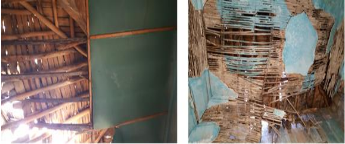
Şekil 0.45 Ahşap Tavanda Bozulmalar
