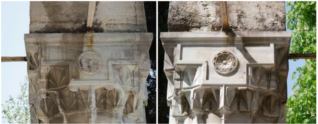
Şekil 3.141 : Mermer Çatlakları, Bakır Oksit ve Korozyon Oluşumu (2022)
