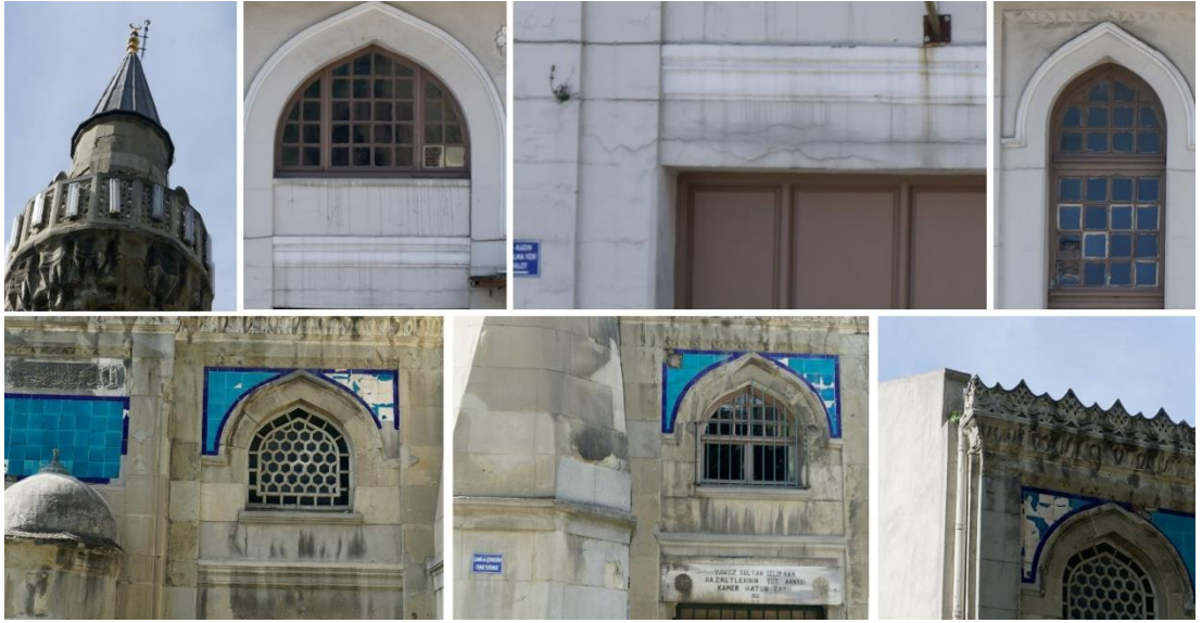
Şekil 3.68 : Kamer Hatun Camii Cephe Bozulmaları (2022)
