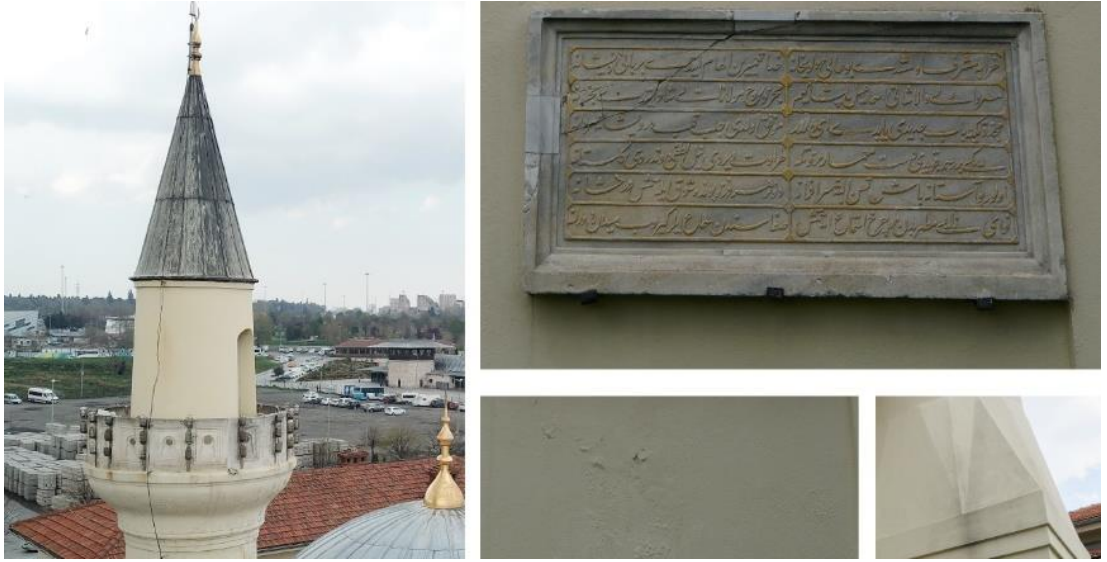
Şekil 3.79 : Yenikapı Mevlevihane Mescidi Cephe Bozulmaları (2022)
