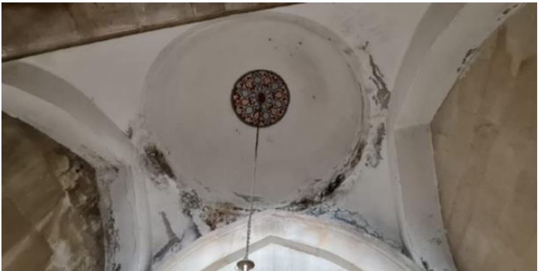
Şekil 3.34 : Bostancı Kuloğlu Cami Ek Yapı Sıva Bozulması (2022)
