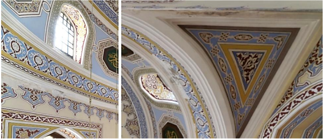
Şekil 3.13 : Harimdeki Sıva-Kalemişi Bozulmaları (2022)
