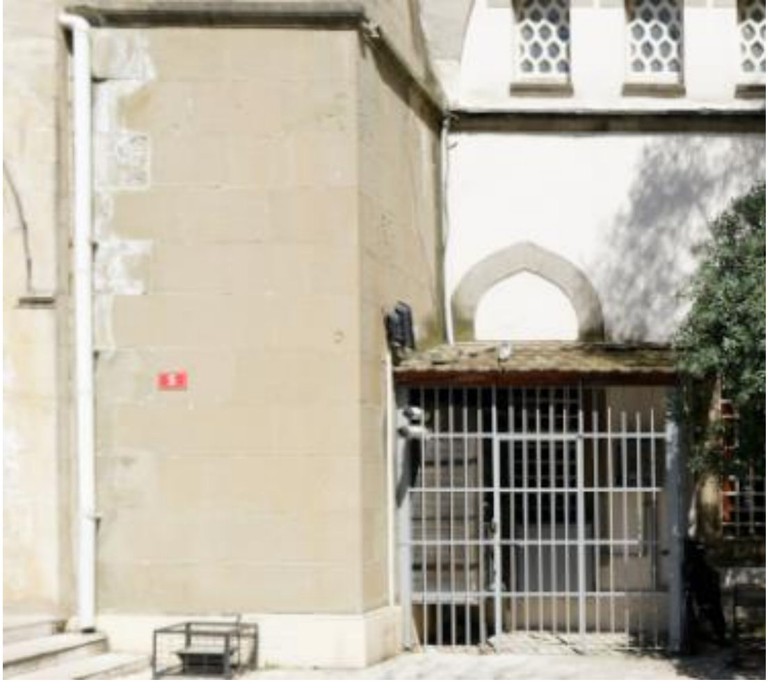
Şekil 3.31 : Bostancı Kuloğlu Cami Cephe Bozulmaları ve Muhdes Ekler (2022)
