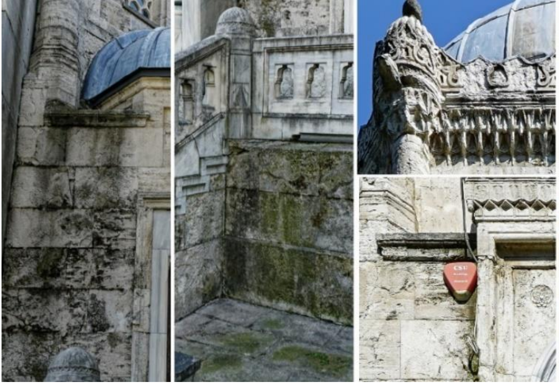
Şekil 3.118: Sultan V. Mehmed Reşad Türbesi Cephe Bozulmaları (2022)
