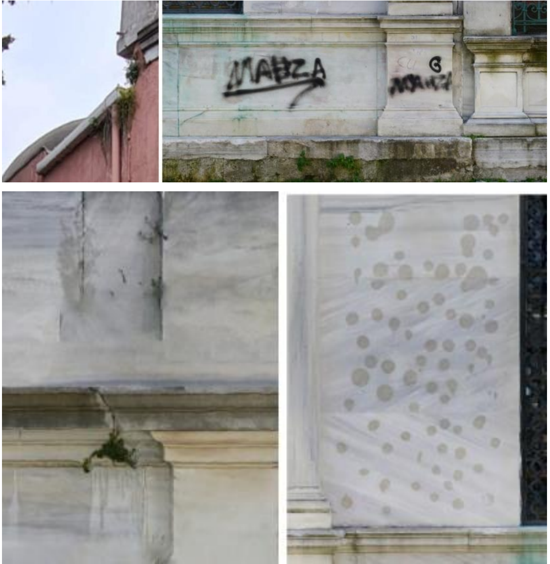
Şekil 3.124: Hasan Hüsnü Paşa Türbesi Cephe Bozulmaları (2022)
