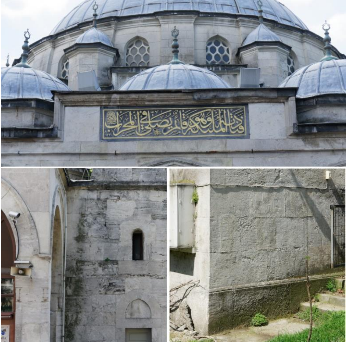
Şekil 3.54 : Amine Hatun Camii Cephe Bozulmaları (2022)
