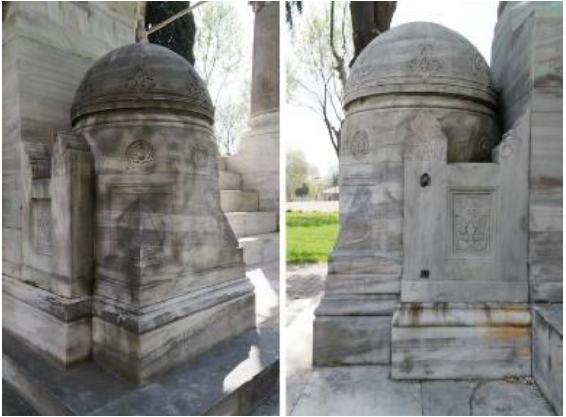
Şekil 3.140 : Mahmut Şevket Paşa Türbesi Siyah Kabuk Oluşumu (2022)
