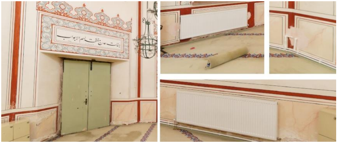
Şekil 3.80 : Harim Sıva-Kalemişi Bozulmaları (2022)
