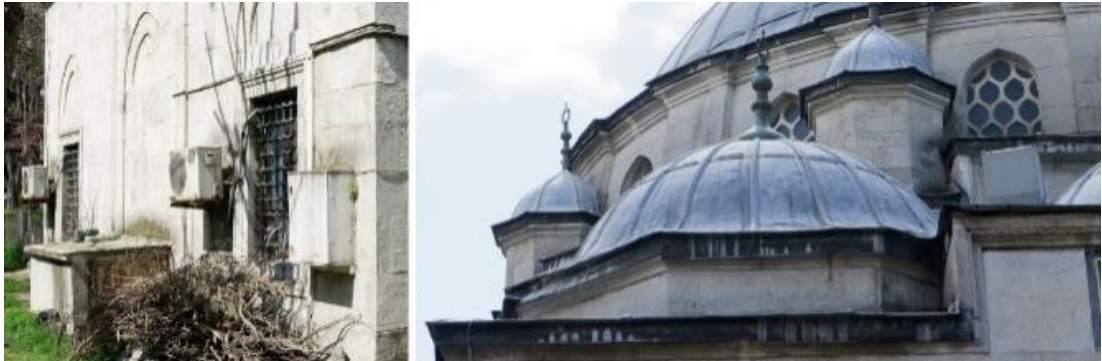
Şekil 3.53 : Amine Hatun Camii Cephe Bozulmaları (2022)
