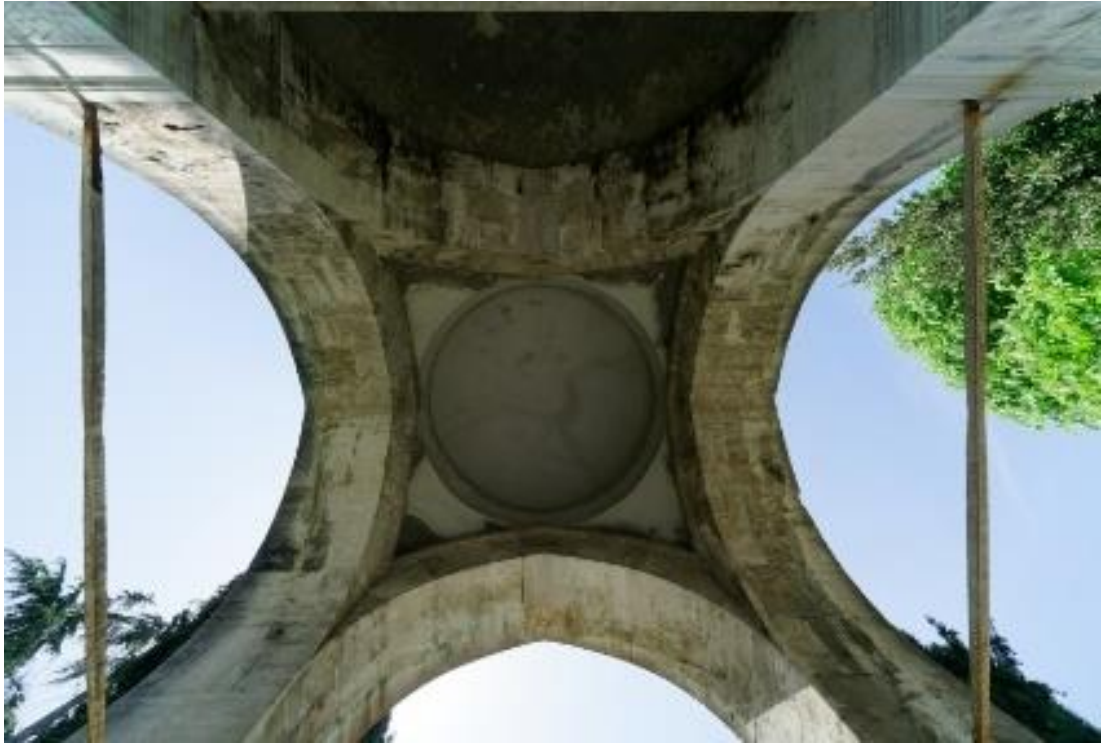
Şekil 3.139 : Mahmut Şevket Paşa Türbesi Siyah Kabuk Oluşumu (2022)
