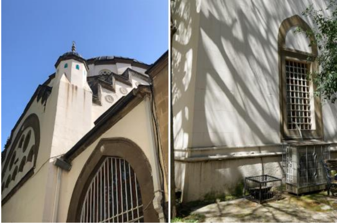
Şekil 3.30 : Bostancı Kuloğlu Cami Cephe Bozulmaları ve Muhdes Ekler (2022)
