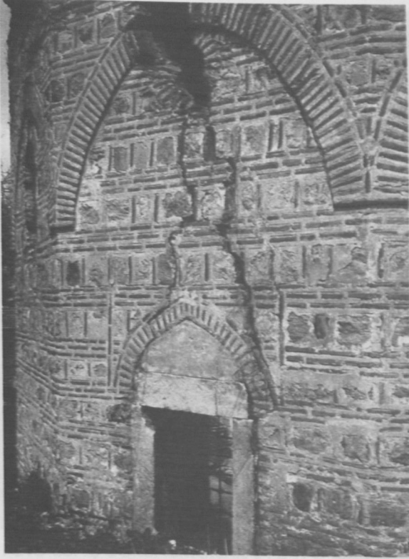
FOTO 28. DOĞU CEPHESİ ( H-J ) (1997 ).
