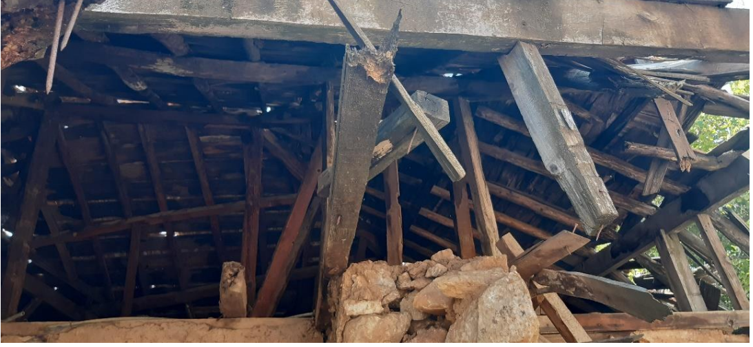
Şekil 3.18 Harap haldeki yapıda görülen çatı detayı (2019)
