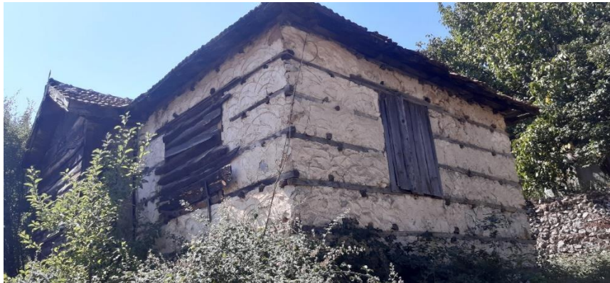
Şekil 3.65 Kötü durumdaki Düğmeli Ev örneği (2019)
