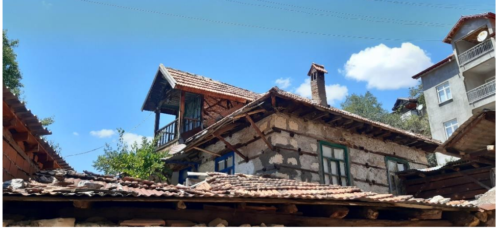
Şekil 3.78 Kötü durumdaki Düğmeli Ev örneği (2020)
