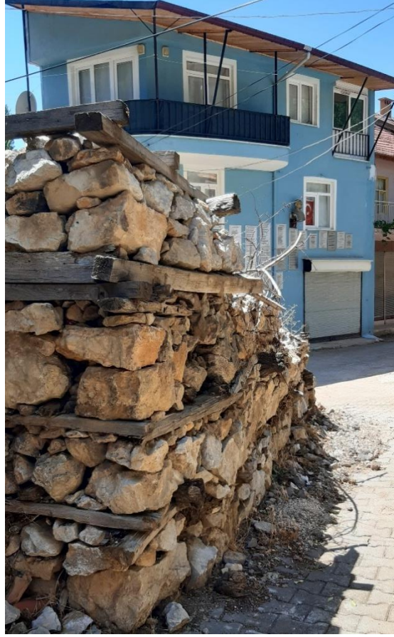
Şekil 3.72 Yıkılmış durumdaki Düğmeli Ev örneği (2020)
