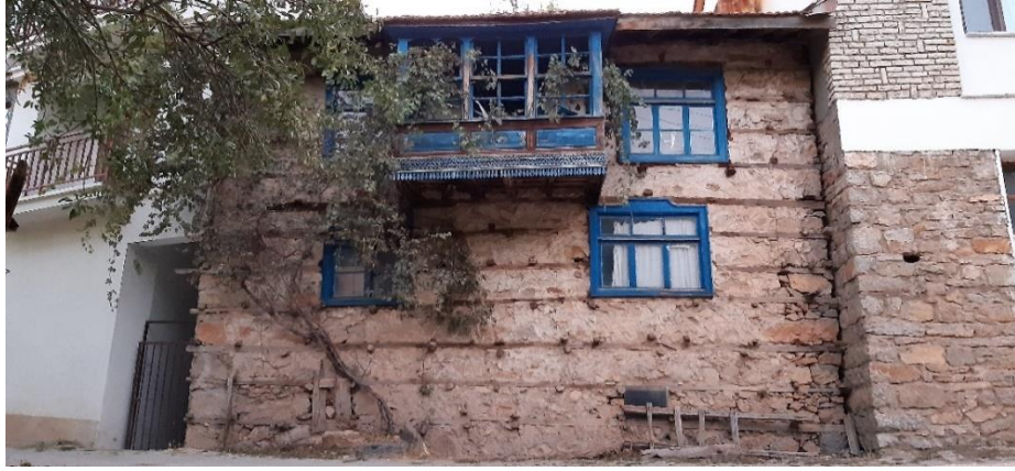
Şekil 3.82 Kullanılmayan kötü durumdaki Düğmeli Ev örneği (2019)
