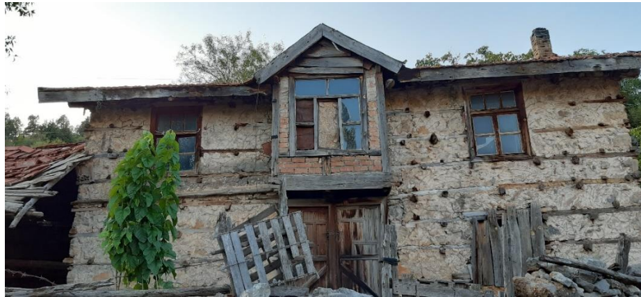
Şekil 3.83 Kullanılmayan harap durumdaki Düğmeli Ev örneği (2019)
