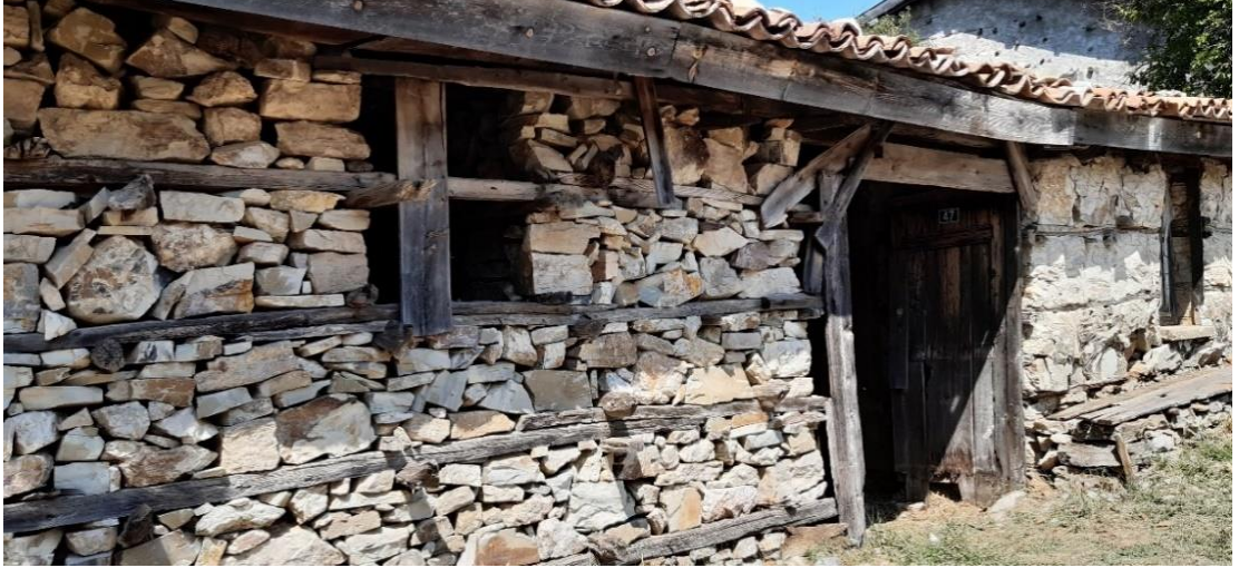
Şekil 3.42 Belenalan Mahallesi kötü durumda Düğmeli Ev örneği. (2019)
