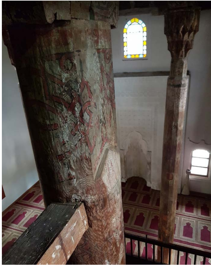
Őekil 5.3: Mahmutbey Camii'nde bulunan bir birleřim (url-7).
