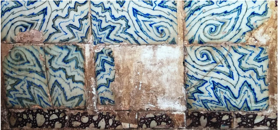
Resim 96: Sol panoda ki alçı ile doldurulan alanlar ve çeşitli tahribatlar
