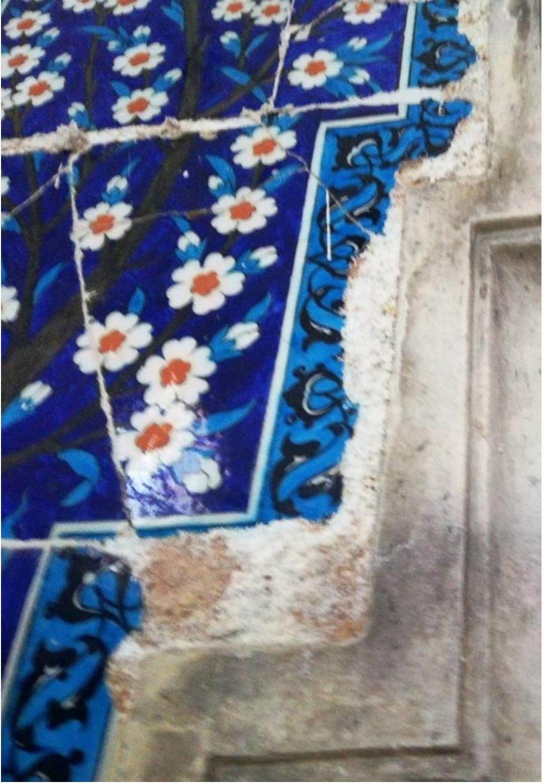
Resim 78: Bordür yüzeyinde ki çatlaklar ve parça kayıpları (detay 3)
