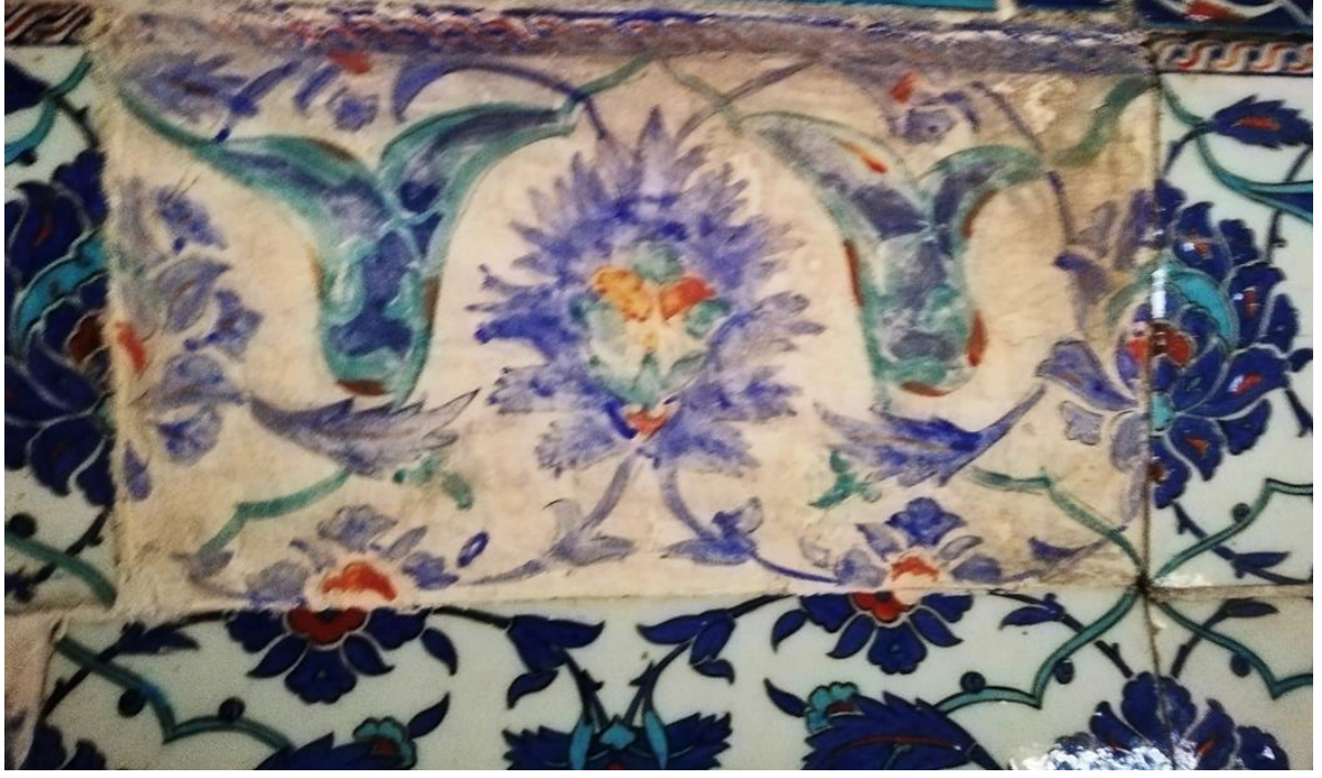
Resim 56: Özensiz restorasyon uygulamasına bir diğer örnek 3
