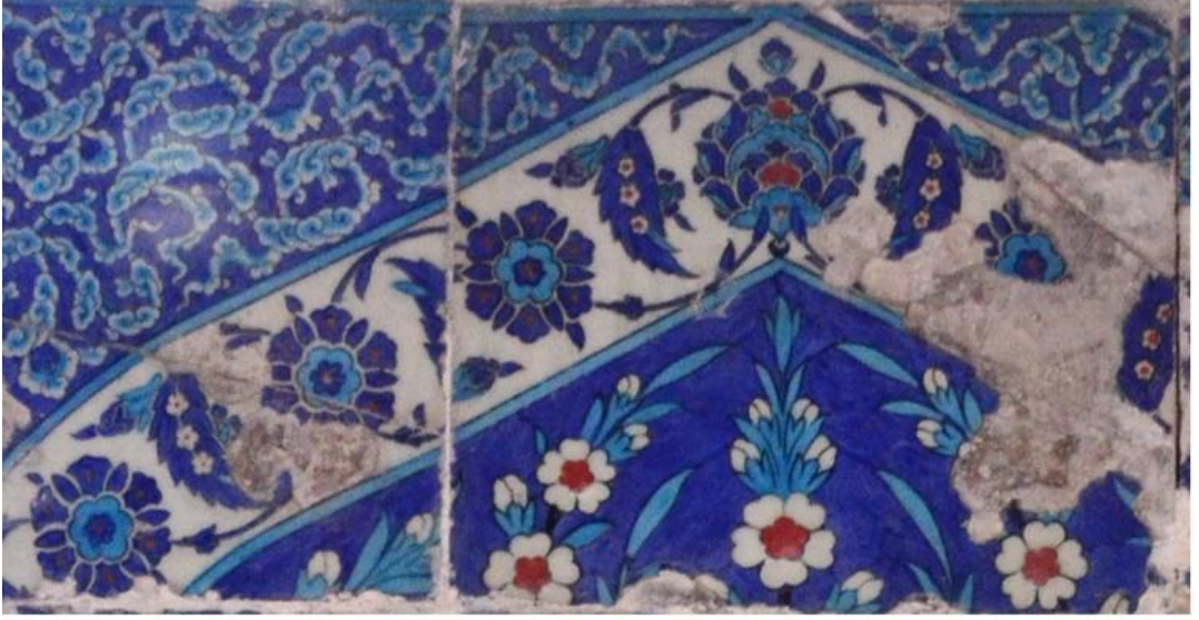
Resim 23: Sađ panonun simetri akseni'nin iki kenarında ki tahribatlar
