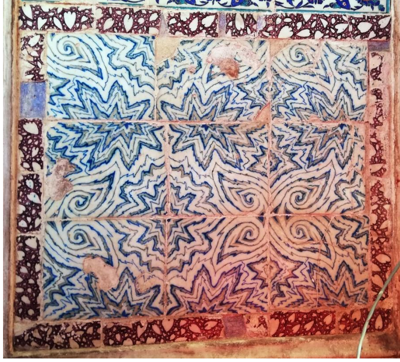
Resim 35: Giriş kapısının sağında yer alan bahar ağaçlı panonun altıda ki mermer görünümlü pano
