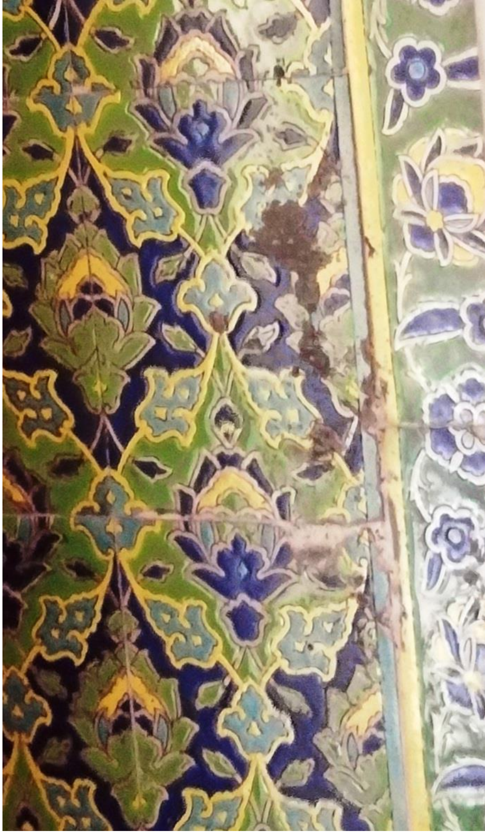
Resim 92: Sol panoda ki mevcut tahribatlar ve yüzeydeki kir birikintilerinden detay görünüm
