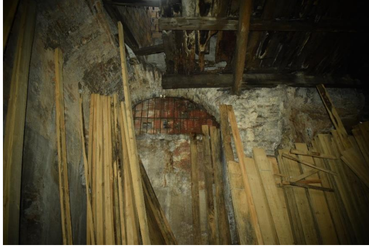
Fotoğraf 165: Ayakapı Hamamı Sıcaklık Güney Duvarı Ve İzleri (Ş.Y.2020)
