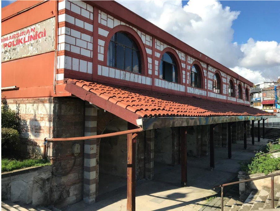
Fotoğraf 230: Yeşil Direkli Hamam Günümüz Taklit Cepheli Ek Yapısı (Ş.Y.2020) Yapılan restorasyon çalışmaları ile külhan bölümü tonozlarının üzerine, hamam mimarisine kontrast malzeme ve formda iki katlı betonarme ek bir yapı yapılmıştır.
