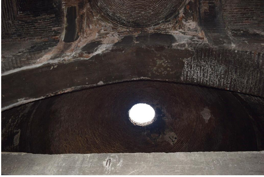
Fotoğraf 160: Ayakapı Hamamı Soyunmalık Kubbesi Yok Olan Aydınlık Feneri (Ş.Y.2020)
