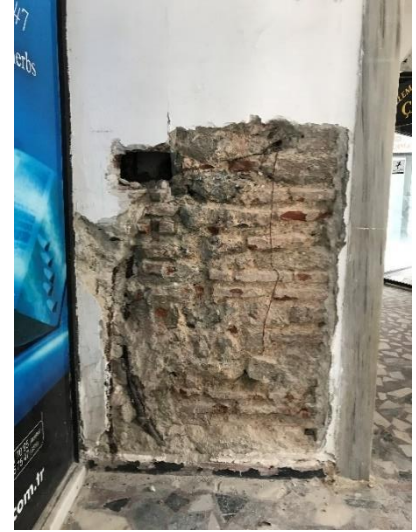
Fotoğraf 200: Yeşil Direkli Hamam Kadınlar Ilıklığı Orta Kubbeli Kısım Raspası (Sıcaklığa Geçiş Yanı) (Ş.Y.2020)
