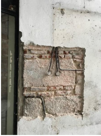
Fotoğraf 217: Yeşil Direkli Hamam Erkekler Sıcaklığı Sıva Raspası (Kuzey Eyvanı) (Ş.Y.2020)
