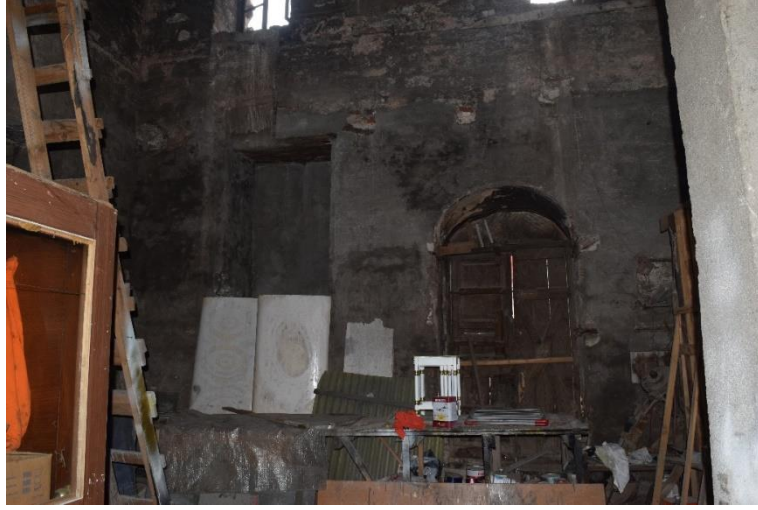
Fotoğraf 147: Ayakapı Hamamı Rüzgarlık Batı Duvarı, Cümle Kapısı Ve Kapatılmış Pencere (Ş.Y.2020)
