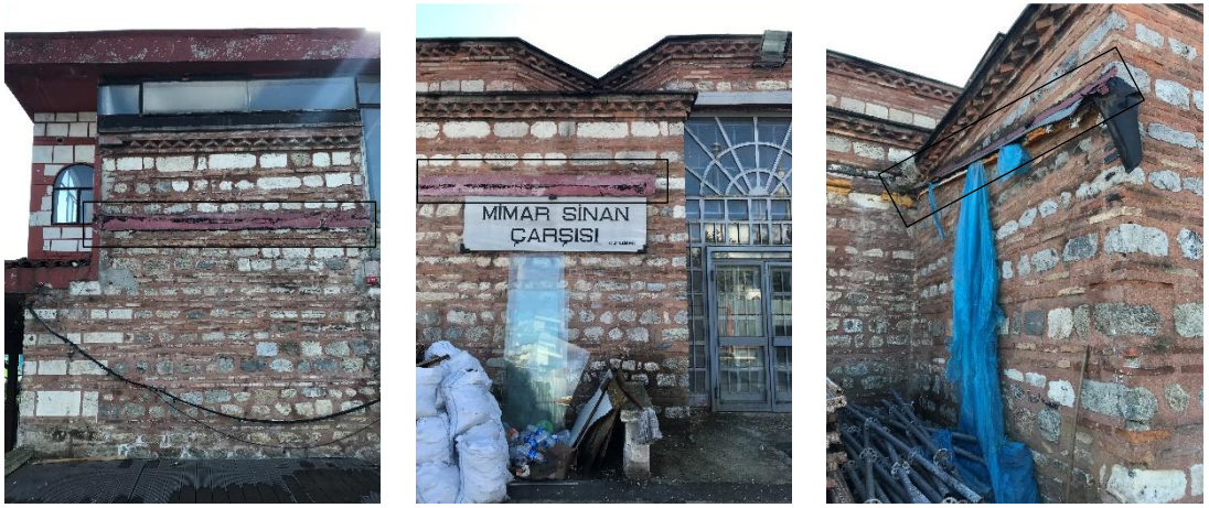
Fotoğraf 246: Yeşil Direkli Hamam Kuzey Cephesi Duvarında Kalan Tente İzleri (Ş.Y.2020)
