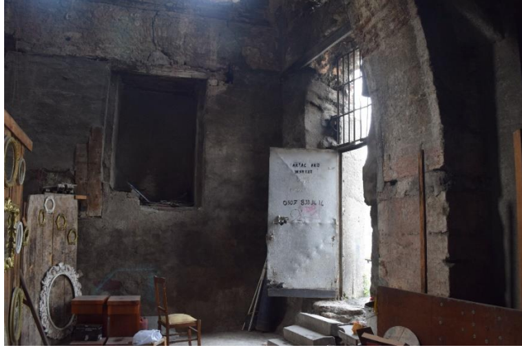
Fotoğraf 152: Ayakapı Hamamı Rüzgarlık Kapatılan Pencere Ve Açılan Giriş Kapısı (Ş.Y.2020)
