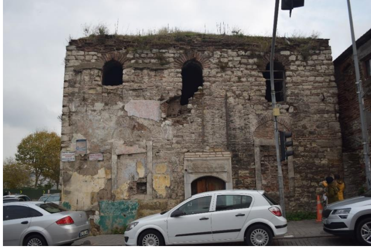
Fotoğraf 154: Ayakapı Hamamı Batı Cehesinden Kaldırılan Ek Yapının Hasarları (Ş.Y.2020)
