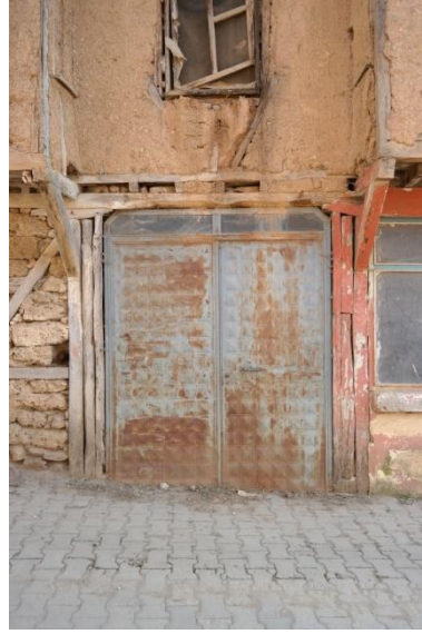
Şekil 4.75 Ahşap kapıların yerini alan demir kapı örneği (M. R. Çakan Arşivi, 2018)
