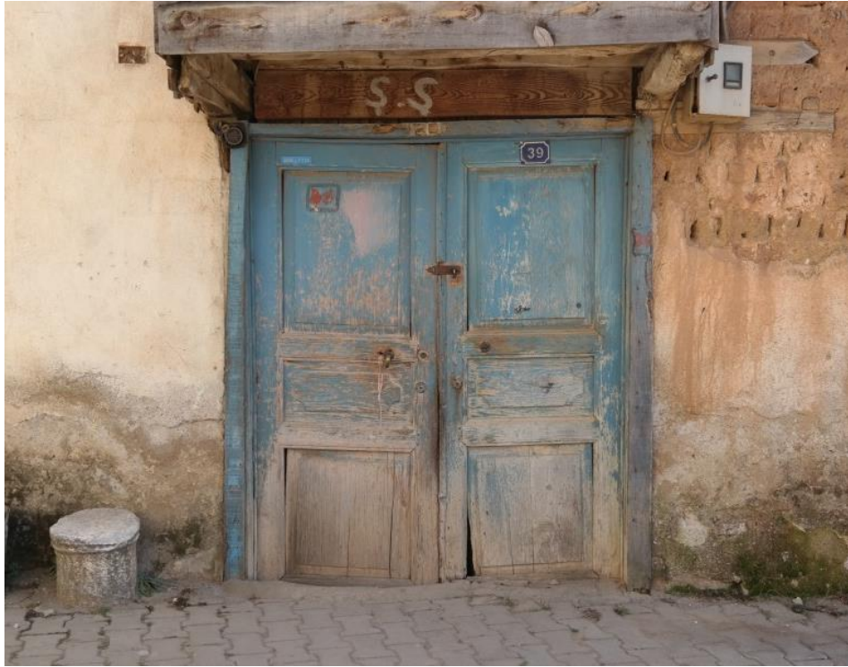
Şekil 4.91 Kapı kenarında yol içerisinde kalmış bir sütun (M. R. Çakan Arşivi, 2018)
