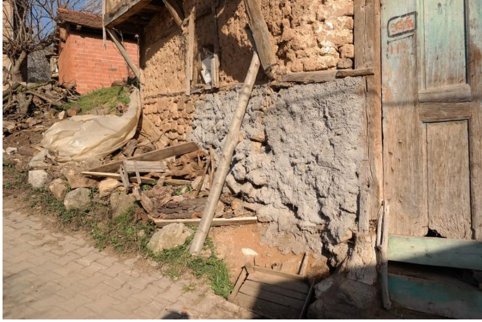
Şekil 4.59 Sıva onarımlarında niteliksiz malzeme kullanımı. Ada/Parsel Numarası: 930/188 (M. R. Çakan Arşivi, 2018)
