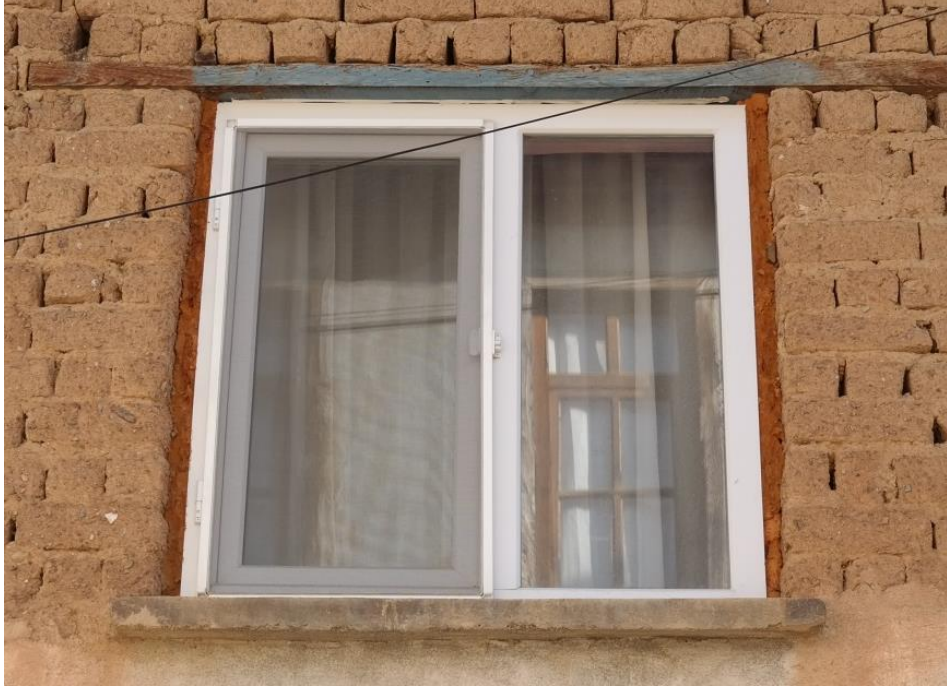
Şekil 4.77 Ahşap pencerelerin yerine takılan pvc pencere örneği. Ada/Parsel Numarası: 930/300 (M. R. Çakan Arşivi, 2018)
