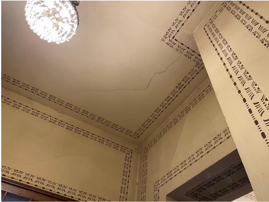
Şekil 5. 210 Surp Hovhan Vosgeperan Ermeni Katolik Kilisesi tavanda ve duvarlarda bulunan çatlak (Özcan, 2021)
