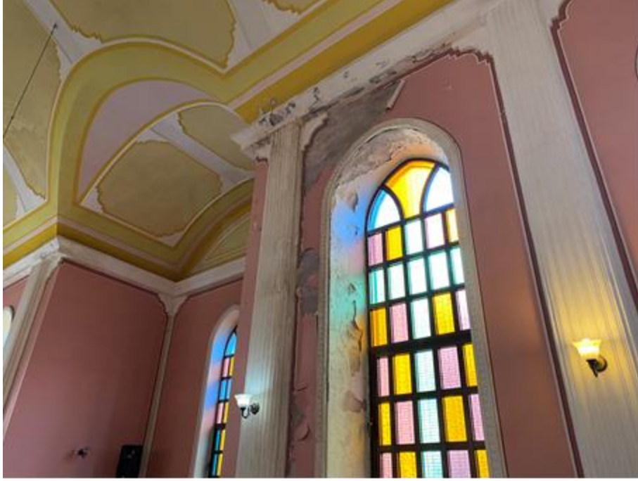
Şekil 5. 256 İncil Kilisesi iç mekanda oluşan sıva dökülmeleri (Özcan, 2022)
