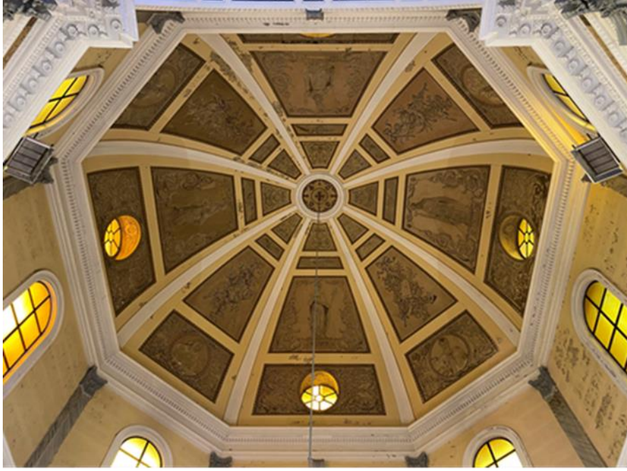
Şekil 5. 212 Surp Hovhan Vosgeperan Ermeni Katolik Kilisesi, kubbeye ve duvarda sıva dökülmeleri (Özcan, 2021)
