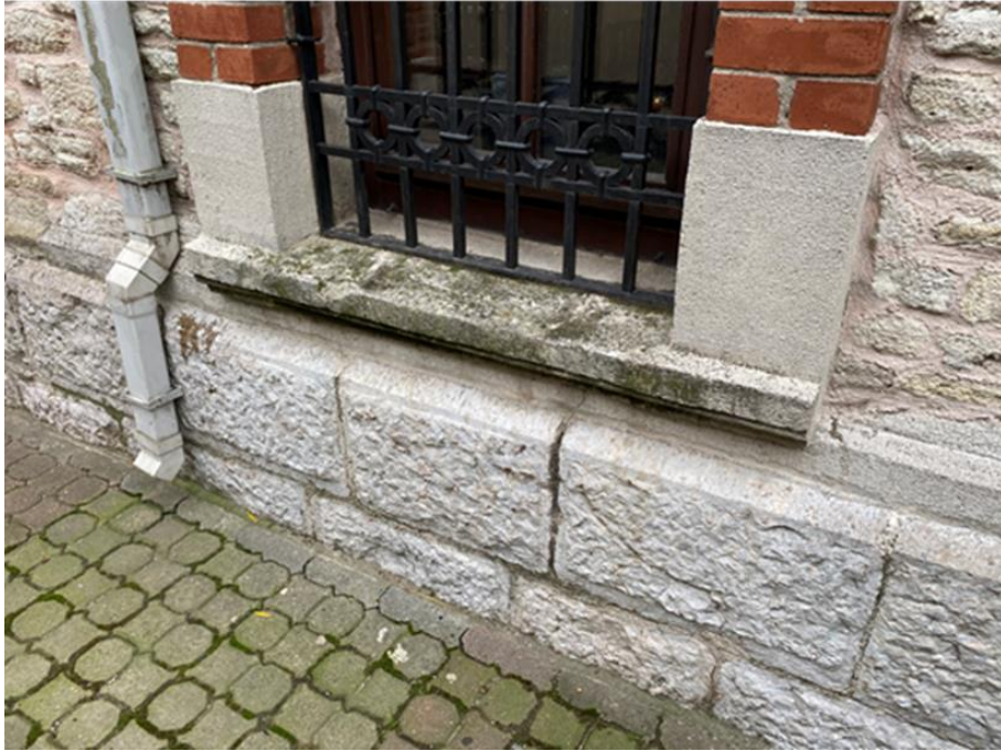
Şekil 5. 99 Surp Pırgiç Ermeni Kilisesi'nin pencere kenarlarında ve zeminde oluşan yosunlanma (Özcan, 2021)
