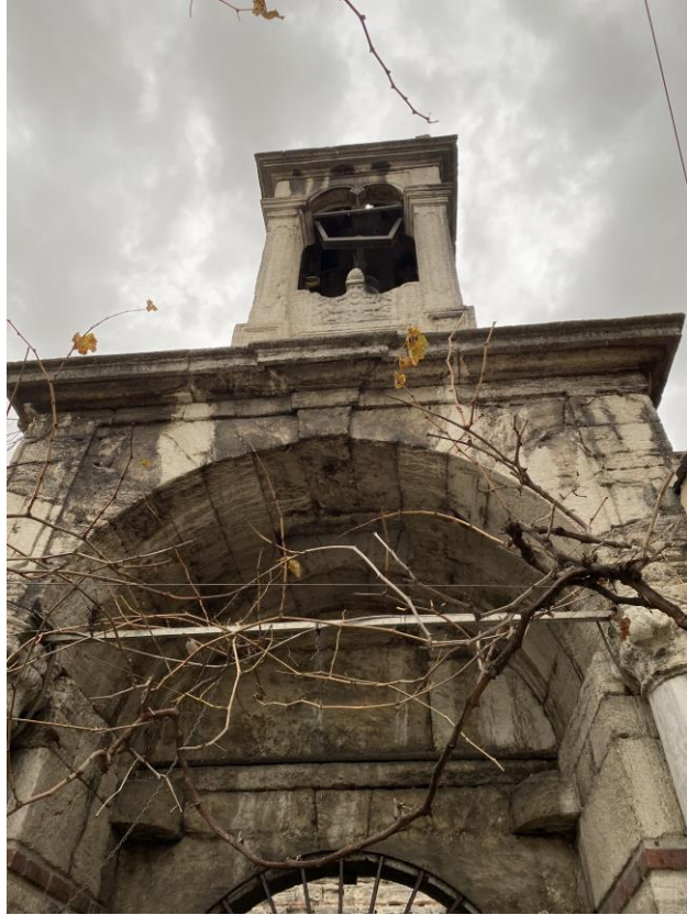
Şekil 5. 55 Surp Nigoğayos Ermeni Kilisesi'nin çan kulesi üzerinde bulunan çatlak, derz boşalmaları, parça kopması ve siyah kabuk oluşumu (Özcan, 2021)
