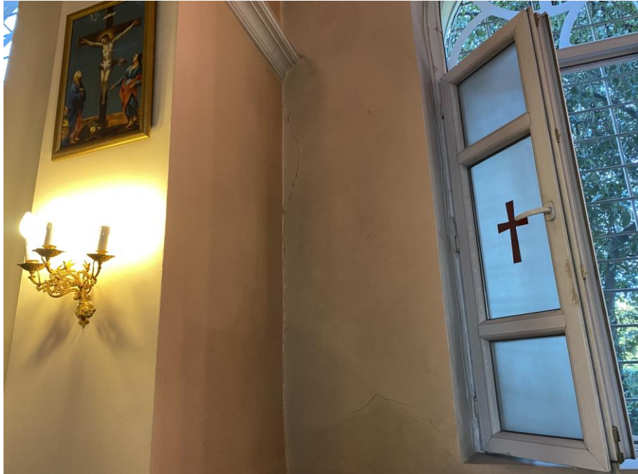
Şekil 5. 231 Surp Levon Ermeni Katolik Kilisesi iç mekanda oluşan sıva çatlakları (Özcan, 2022)
