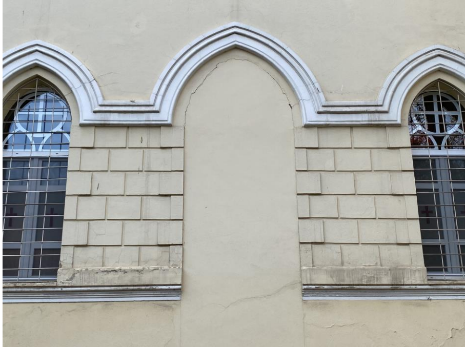
Şekil 5. 228 Surp Levon Ermeni Katolik Kilisesi'nin güney cephesinde bulunan çatlaklar (Özcan, 2022)
