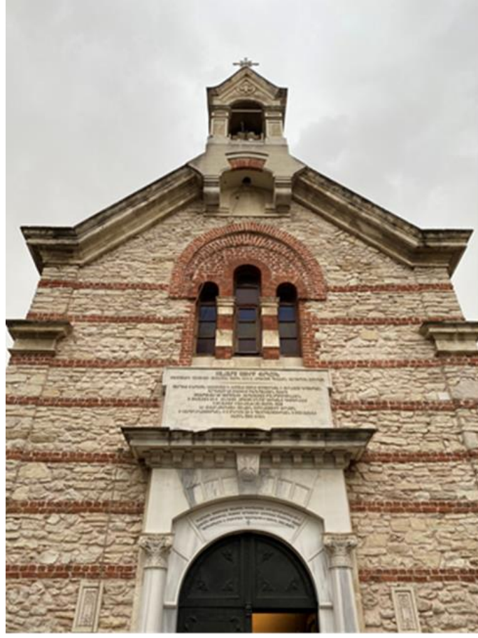
Şekil 5. 100 Surp Pırgiç Ermeni Kilisesi'nin batı cephesinde bulunan siyah kabuk oluşumu ve yıkanmalar (Özcan, 2021)
