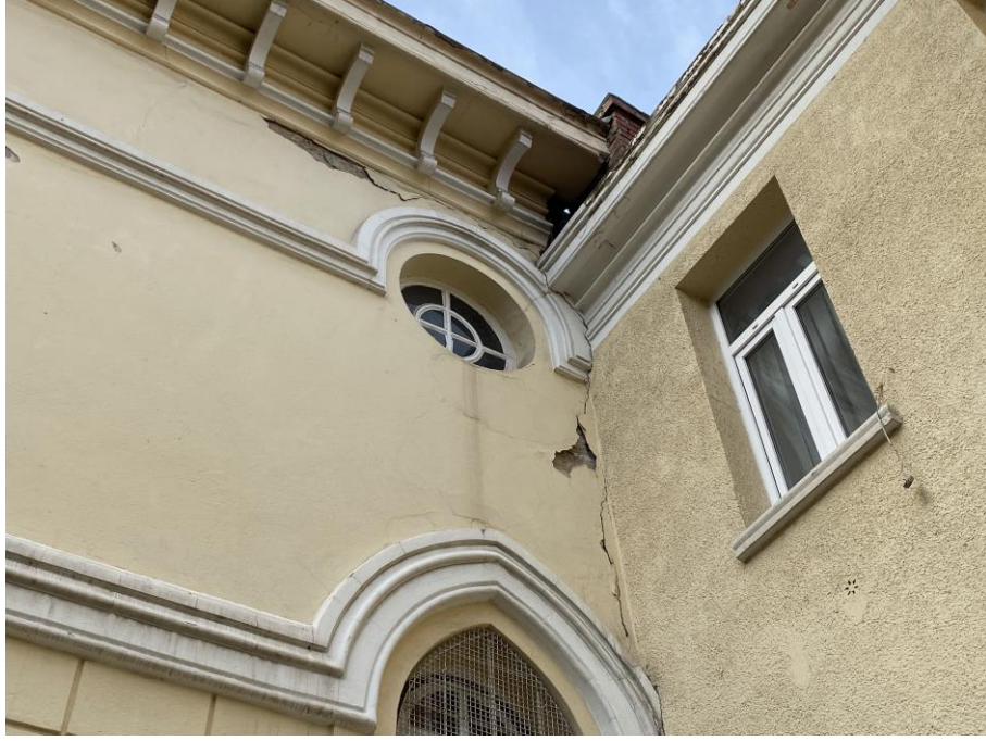
Şekil 5. 229 Surp Levon Ermeni Katolik Kilisesi'nin güney cephesinde bulunan çatlaklar ve sıva dökülmesi (Özcan, 2022)
