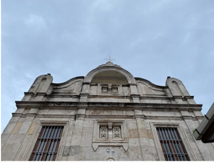
Şekil 5. 43 Surp Hagop Ermeni Kilisesi batı cephesi üzerinde oluşan kabuklaşma (Özcan, 2021)
