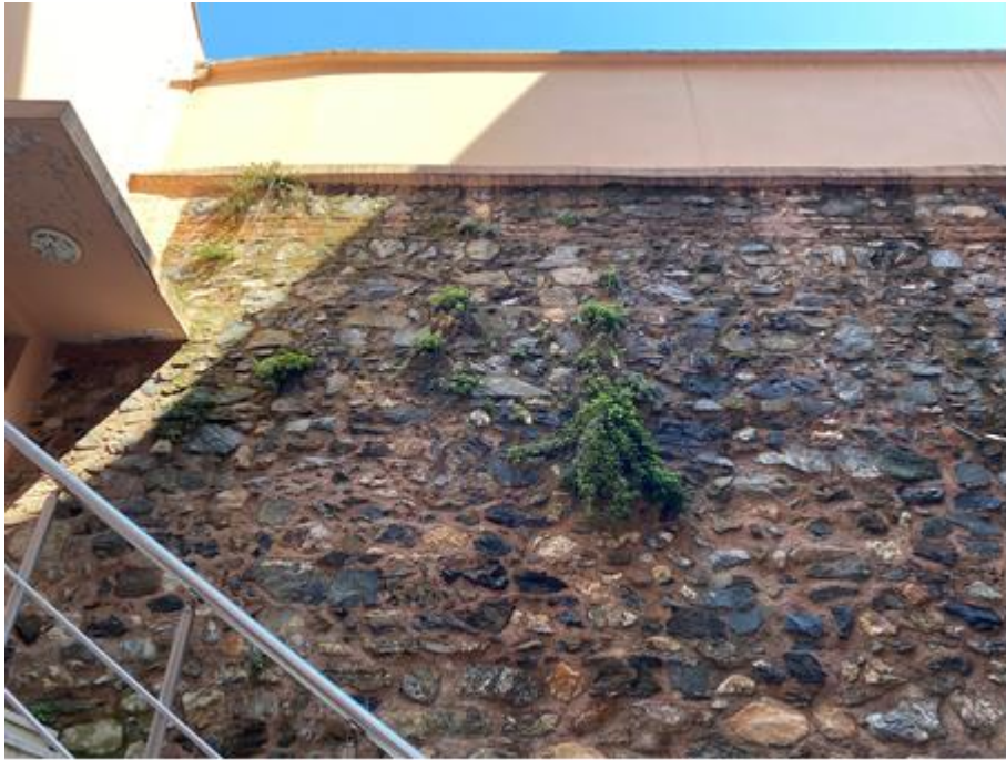
Şekil 5. 149 Surp Asdvadzadzin Ermeni Kilisesi cephe duvarları üzerinde oluşan bitkilenme (Özcan, 2022)
