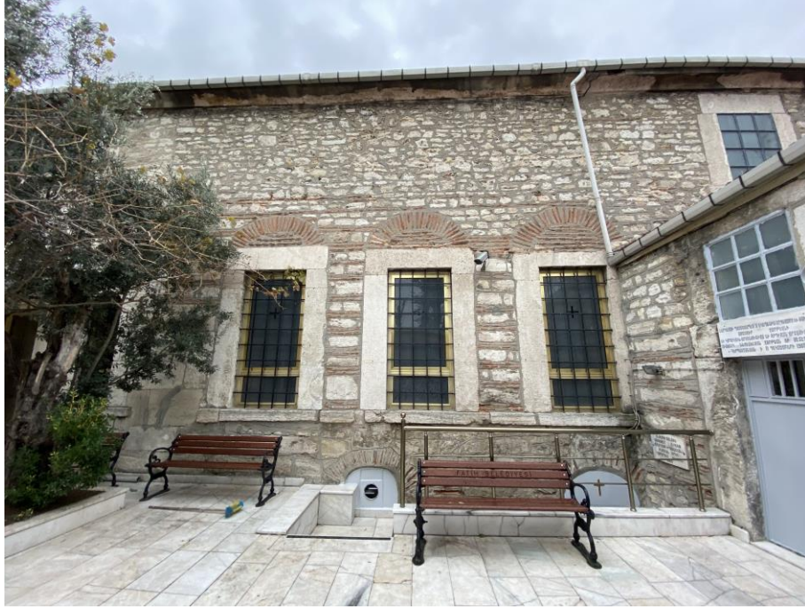
Şekil 5. 57 Surp Nigoğayos Ermeni Kilisesi'nin güney cephesinde bulunan siyah kabuk oluşumu, yıkanmalar ve özgün yapıya uygun olmayan doğrama kullanımı (Özcan, 2021)
