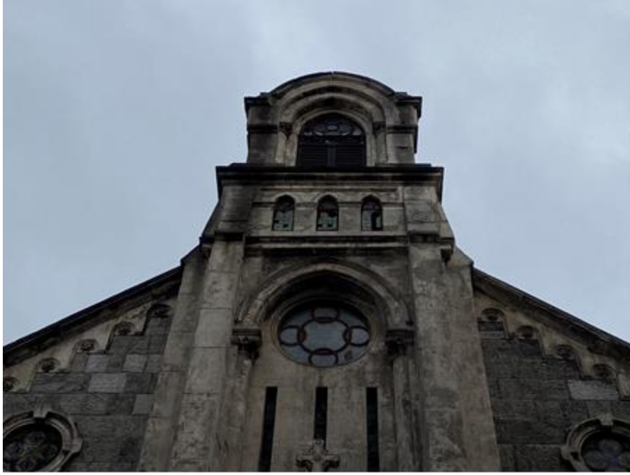
Şekil 5. 243 Aynalıçeşme Avedaragan Amenasurp Yerrortutyun Ermeni Kilisesi'nin batı cephesi üzerinde oluşan çatlak, siyah kabuk oluşumu ve yıkanmalar, çan kulesi üzerinde bulunan kırık cam (Özcan, 2022)
