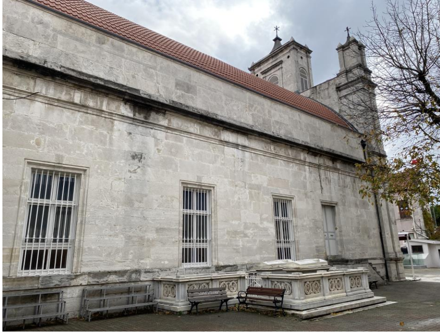
Şekil 5. 28 Surp Kevork Ermeni Kilisesi'nin kuzey cephesinde bulunan siyah kabuk oluşumu ve yıkanmalar (Özcan, 2021)
