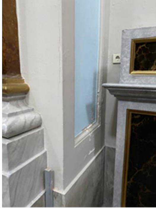
Şekil 5. 196 Surp Asdvadzadzin Ermeni Kilisesi, boya dökülmesi (Özcan, 2021)
