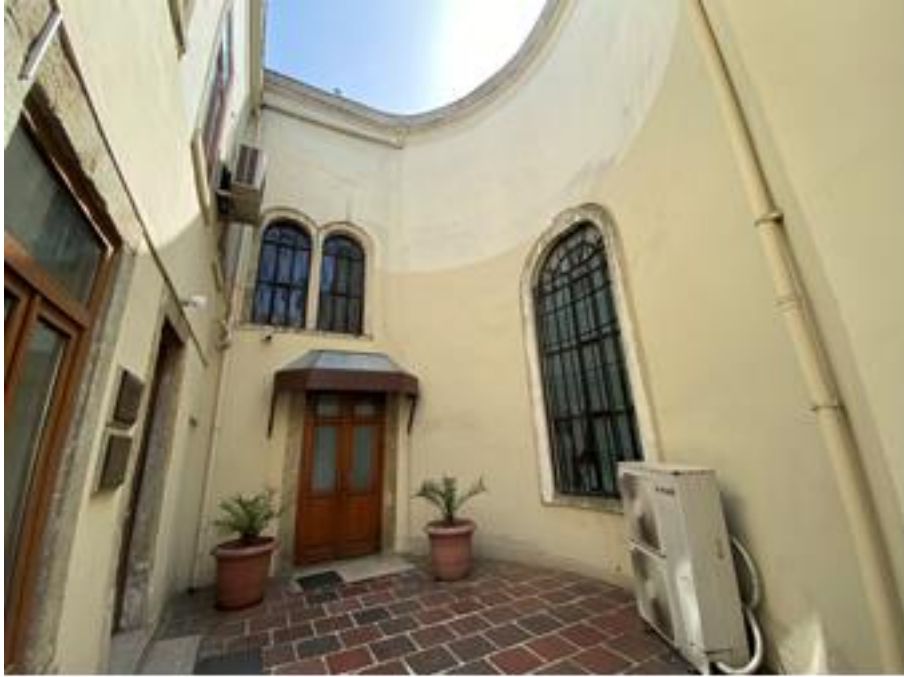
Şekil 5. 166 Surp Takavor Ermeni Kilisesi cephe duvarları üzerinde oluşan kılcal çatlaklar (Özcan, 2022)
