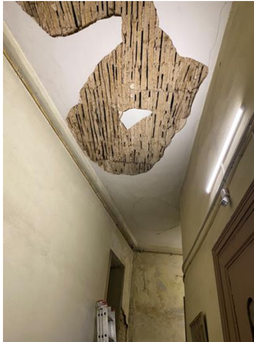
Şekil 5. 217 Surp Hovhan Vosgeperan Ermeni Katolik Kilisesi'nin apsit arkasında bulunan bölümde tavanda çürüme ve duvarlarında rutubetlenme (Özcan, 2021)
