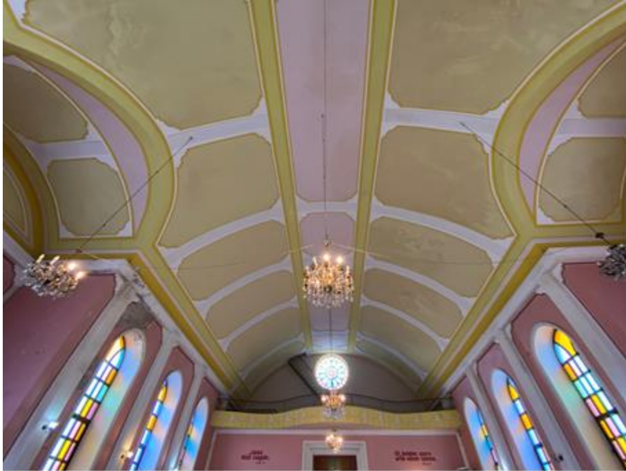
Şekil 5. 257 İncil Kilisesi tonozda oluşan rutubetlenme (Özcan, 2022)
