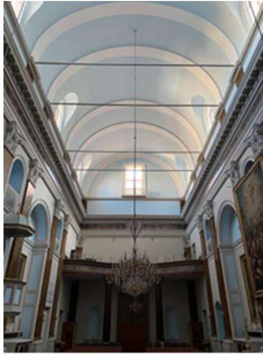
Şekil 5. 197 Surp Asdvadzadzin Ermeni Katolik Kilisesi, tonozda rutubetlenme ve boya dökülmesi (Özcan, 2021)
