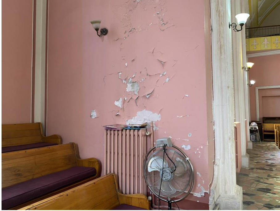
Şekil 5. 258 İncil Kilisesi iç mekanda oluşan boya dökülmeleri (Özcan, 2022)
