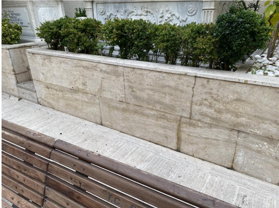
Şekil 5. 70 Surp Asdvadzadzin Kilisesi'nin mezarlık bölümünde bulunan traverten kaplamalar üzerinde oluşan çatlaklar (Özcan, 2021)
