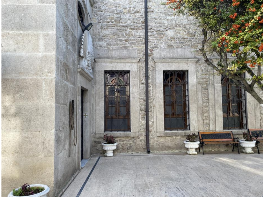
Şekil 5. 83 Surp Stepanos Kilisesi'nin cephe duvarı üzerinde oluşan derz boşalmaları (Özcan, 2021)
