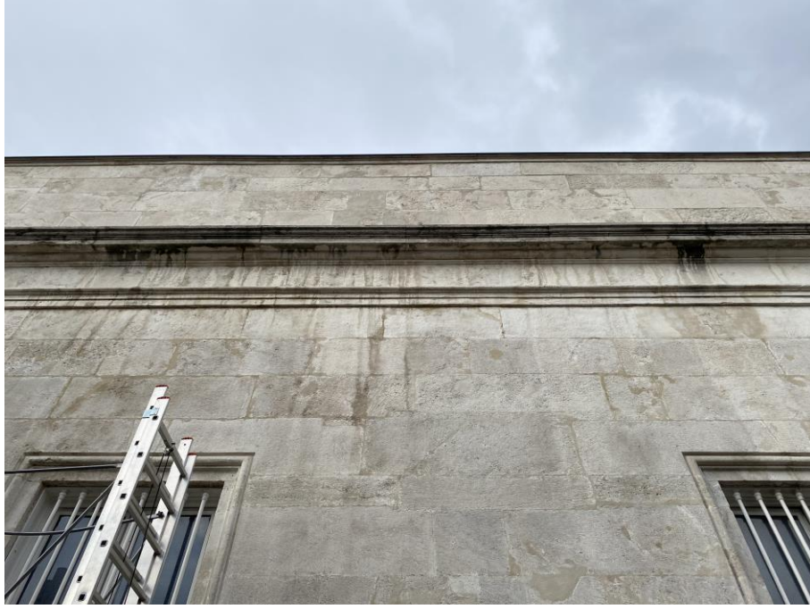
Şekil 5. 29 Surp Kevork Ermeni Kilisesi'nin güney cephesinde bulunan yıkanmalar ve dolgu müdahalesi (Özcan, 2021)
