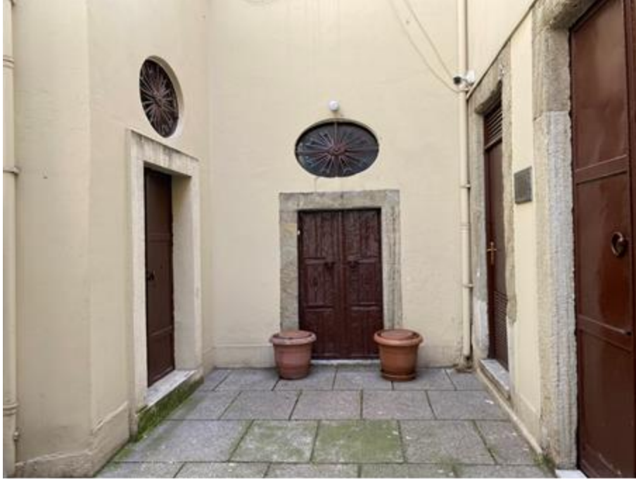
Şekil 5. 167 Surp Takavor Ermeni Kilisesi'nin cephe diplerinde ve zeminde oluşan yosunlanma (Özcan, 2022)
