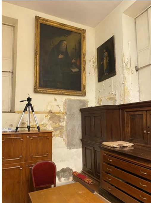
Şekil 5. 215 Surp Hovhan Vosgeperan Ermeni Katolik Kilisesi muganniler soyunma odasının duvarlarında rutubetlenme ve sıva dökülmesi (Özcan, 2021)
