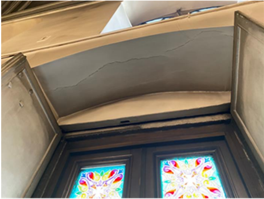
Şekil 5. 169 Vaftizhane giriş kapısı üzerinde bulunan sıva çatlağı (Özcan, 2022)
