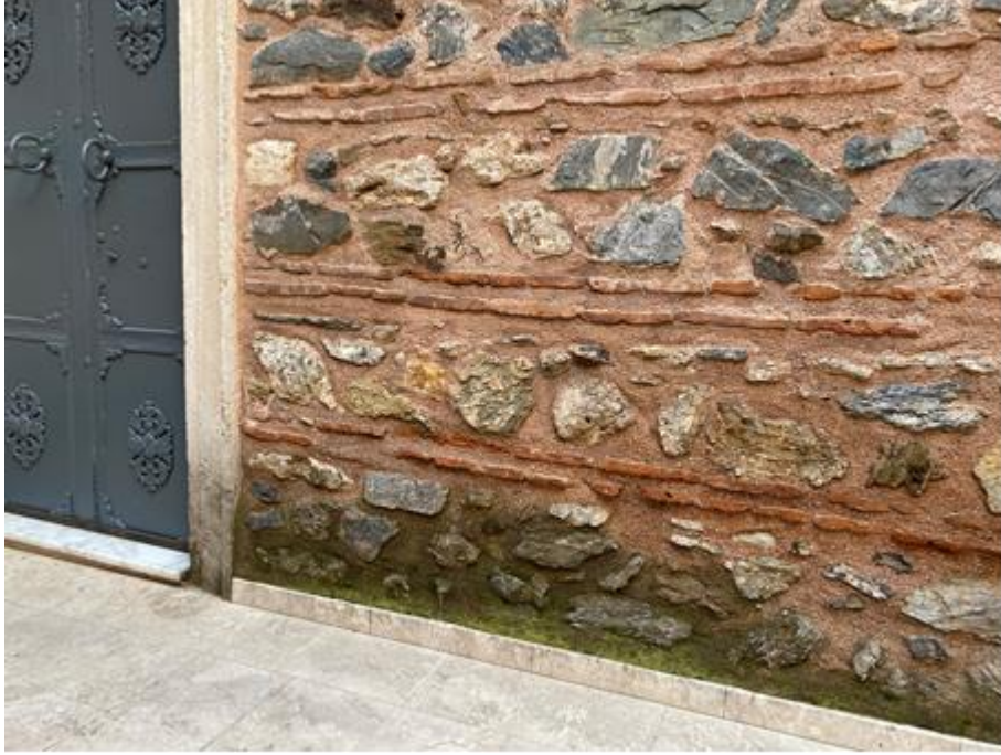
Şekil 5. 148 Surp Asdvadzadzin Ermeni Kilisesi cephe diplerinde oluşan yosunlanma (Özcan, 2022)
