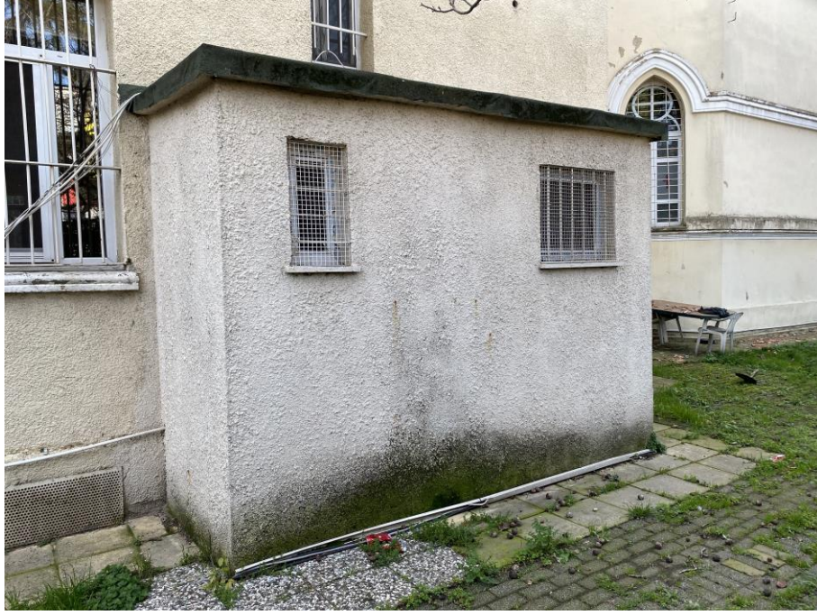
Şekil 5. 234 Surp Levon Ermeni Katolik Kilisesi cephede oluşan yosunlanma (Özcan, 2022)
