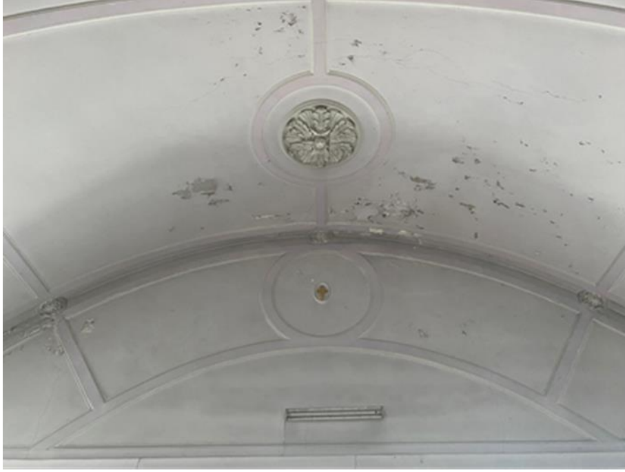
Şekil 5. 185 Surp Garabed Ermeni Kilisesi'nin tonozunda oluşan boya dökülmesi (Öykü, 2022)
