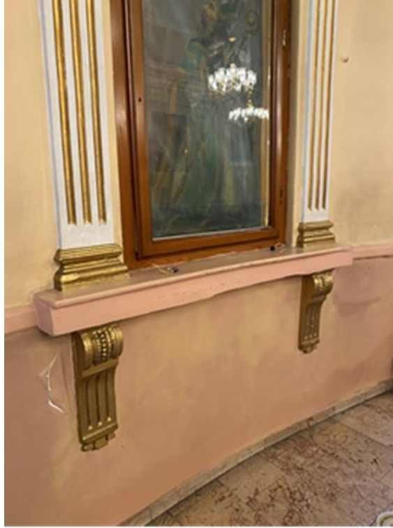
Şekil 5. 110 Surp Vartanants Kilisesi iç mekanda görülen çatlaklar (Özcan, 2021)
