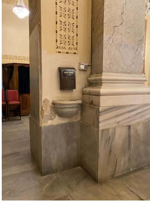
Şekil 5. 214 Surp Hovhan Vosgeperan Kilisesi narteks bölümü sıva dökülmesi (Özcan, 2021)
