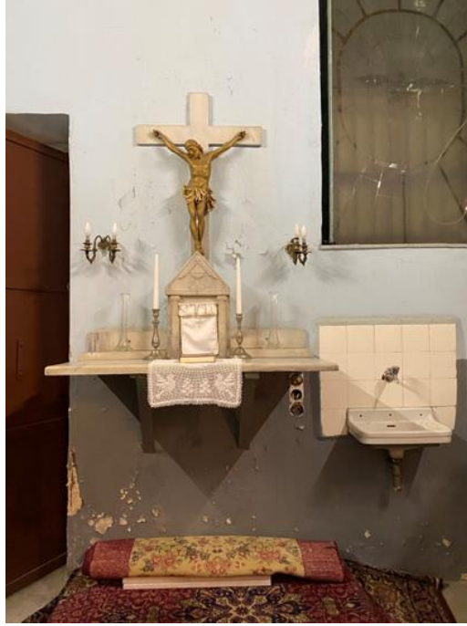
Şekil 5. 216 Surp Hovhan Vosgeperan Ermeni Katolik Kilisesi, vaftiz odası sıva dökülmeleri (Özcan, 2021)
