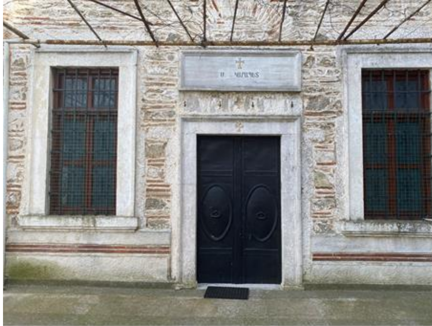
Şekil 5. 184 Surp Garabed Ermeni Kilisesi'nin cephe duvarları üzerinde bulunan derz boşalmaları ve yosunlanma (Öykü, 2022)
