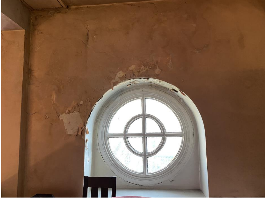
Şekil 5. 232 Surp Levon Ermeni Katolik Kilisesi galeri katında oluşan rutubetlenme ve boya dökülmesi (Özcan, 2022)
