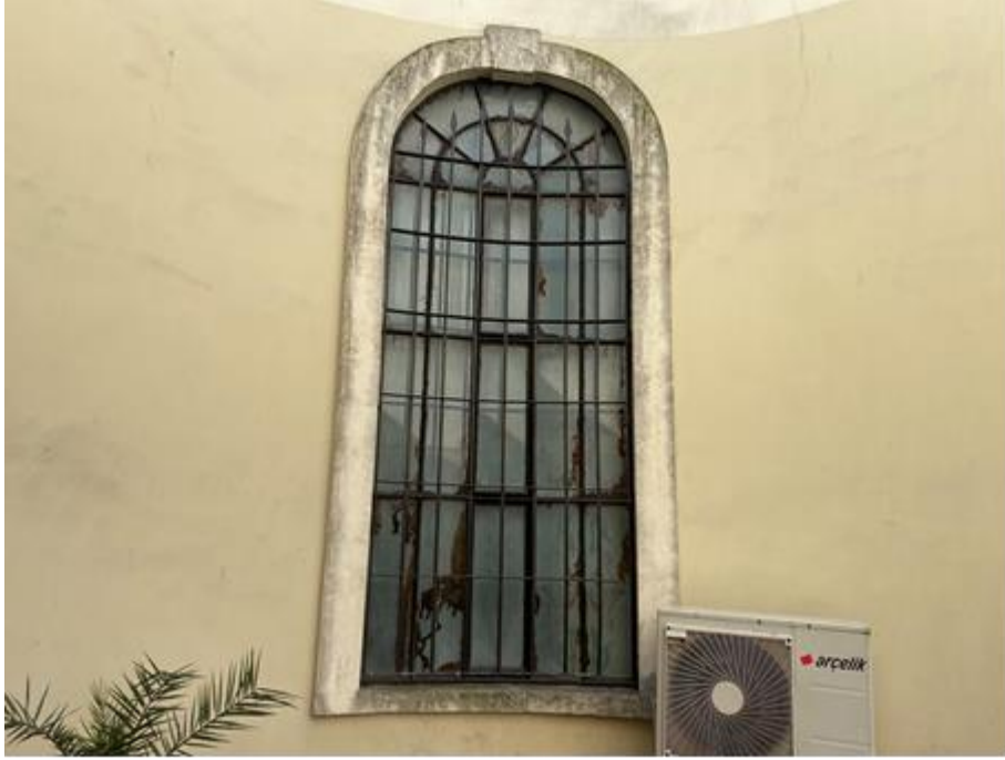
Şekil 5. 168 Surp Takavor Ermeni Kilisesi'nin pencere sövelerindeki yüzey kirliliği ve demir parmaklıklarında oluşan korozyon (Özcan, 2022)
