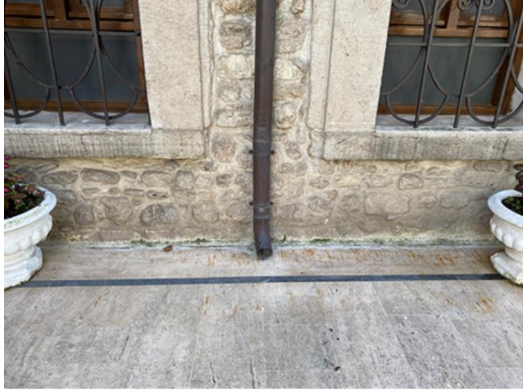
Şekil 5. 84 Surp Stepanos Kilisesi'nin cephe duvarı üzerinde oluşan yıkanmalar ve yosunlanma (Özcan, 2021)
