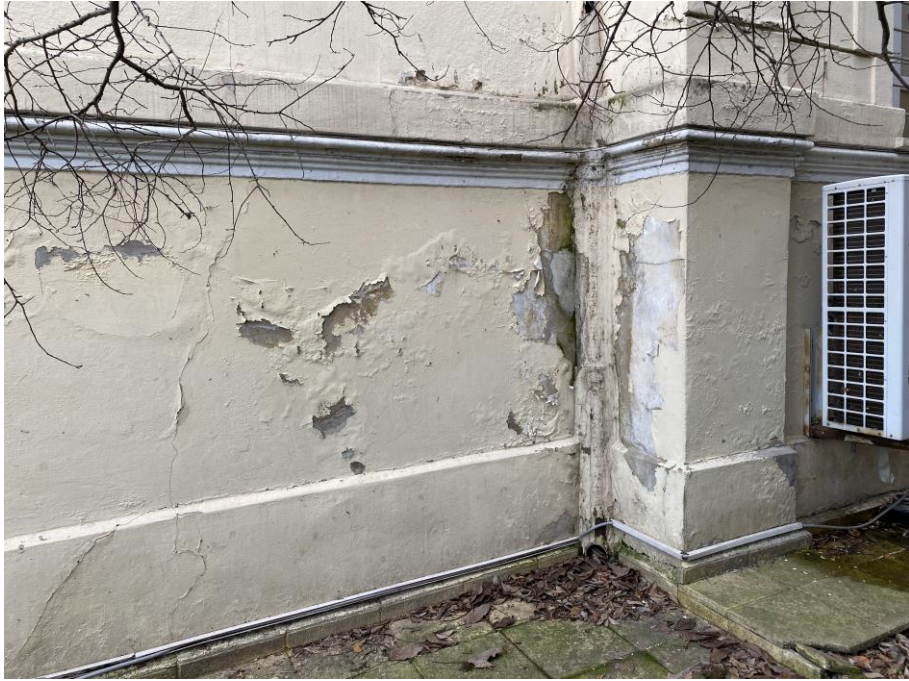
Şekil 5. 233 Surp Levon Ermeni Katolik Kilisesi cephede oluşan sıva dökülmesi ve yosunlanma (Özcan, 2022)
