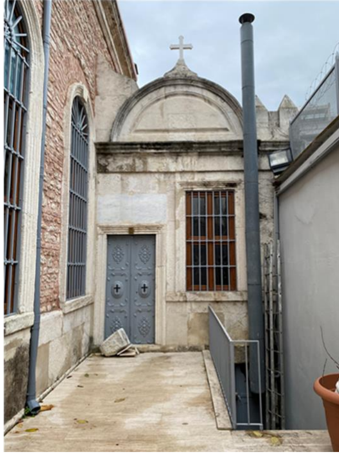
Şekil 5. 42 Surp Hagop Ermeni Kilisesi muganniler soyunma odası dış cephe üzerinde görülen yıkanmalar ve siyah kabuk oluşumu (Özcan, 2021)
