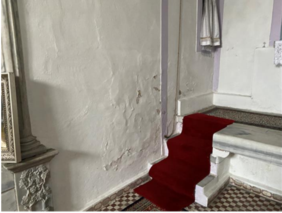
Şekil 5. 186 Surp Garabed Ermeni Kilisesi'nin şapelinde oluşan kabarmalar ve boya dökülmeleri (Öykü, 2022)
