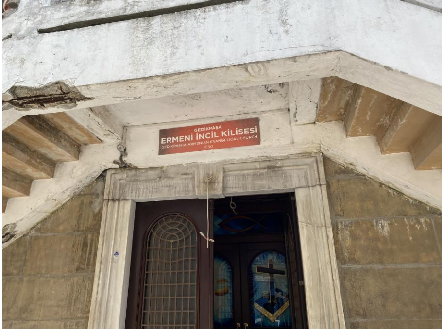
Şekil 5. 255 Gedikpaşa Ermeni İncil Kilisesi'nin merdivenlerinde görülen çatlak ve parça kopması (Özcan, 2022)
