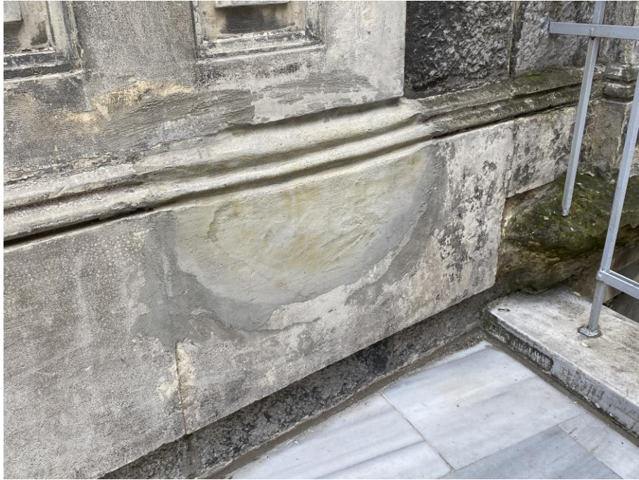
Şekil 5. 245 Aynalıçeşme Avedaragan Amenasurp Yerrortutyun Ermeni Kilisesi'nin batı cephesi üzerinde bulunan çimento esaslı sıva müdahalesi (Özcan, 2022)
