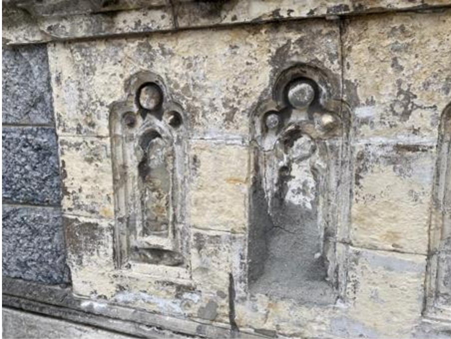
Şekil 5. 242 Aynalıçesme Avedaragan Amenasurp Yerrortutyun Ermeni Kilisesi'nin avlu duvarlarında taş yüzeylerde kayıplar ve oluşan çatlaklar (Özcan, 2022)
