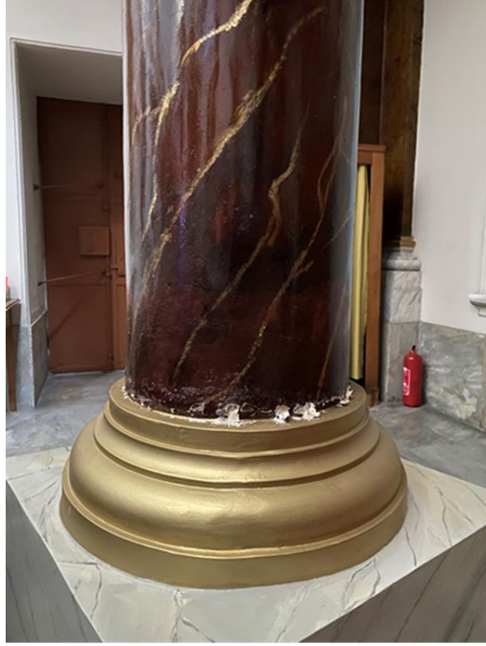
Şekil 5. 198 Surp Asdvadzadzin Ermeni Katolik Kilisesi mermer taklidi yapan sütunlarda boya dökülmesi (Özcan, 2021)
