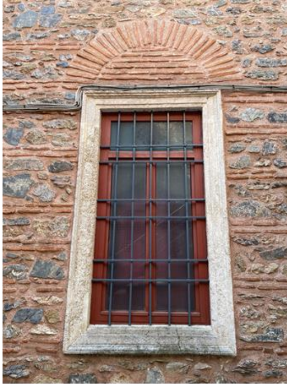
Şekil 5. 145 Surp Asdvadzadzin Ermeni Kilisesi pencere sövesinde bulunan çatlak (Özcan, 2022)
