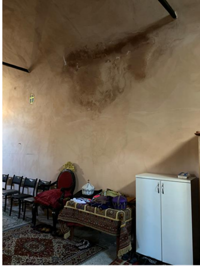
Şekil 5. 15 Balat Surp Hıreşdagabet Kilisesi'nin muganniler soyunma odası duvarında oluşan rutubetlenme (Özcan 2021)
