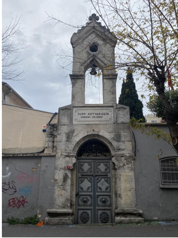
Şekil 5. 68 Kilisenin çan kulesi üzerinde görülen çatlak, aşınma, kabuklaşma ve bitkilenme (Özcan,2021)
