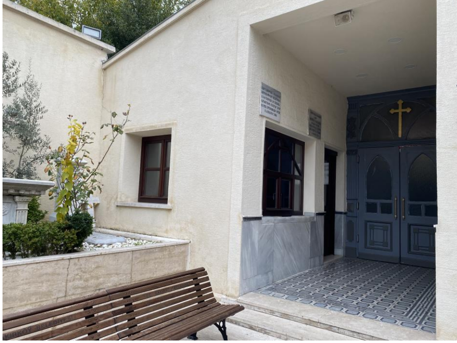
Şekil 5. 71 Surp Asdvadzadzin Kilisesi'nin mezarlık bölümünde oluşan rutubetlenme (Özcan, 2021)
