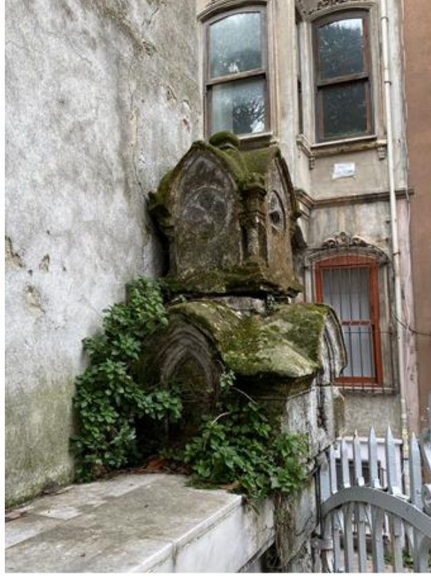
Şekil 5. 246 Aynalıçeşme Avedaragan Amenasurp Yerrortutyun Ermeni Kilisesi'nin avlusunda oluşan yosunlanma (Özcan, 2022)
