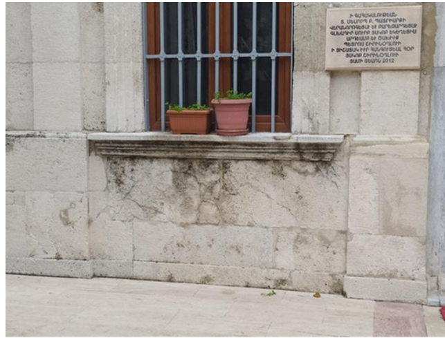
Şekil 5. 41 Surp Hagop Ermeni Kilisesi batı cephesi üzerinde bulunan çatlaklar. (Özcan, 2021)
