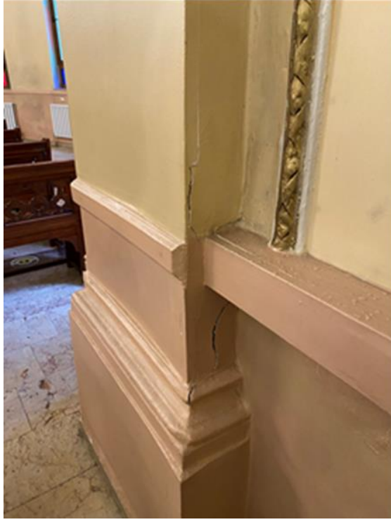
Şekil 5. 111 Surp Vartanants Ermeni Kilisesi sıva çatlakları (Özcan, 2021)
