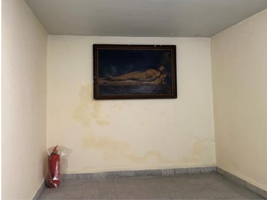
Şekil 5. 147 Galeri katına çıkan merdivenlerde oluşan rutubet (Özcan, 2022)
