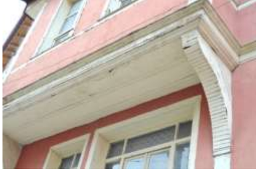
Şekil B. 90. Kütahya Konağı güneydoğu cephesi, ahşap payanda (Ocak, 2019).
