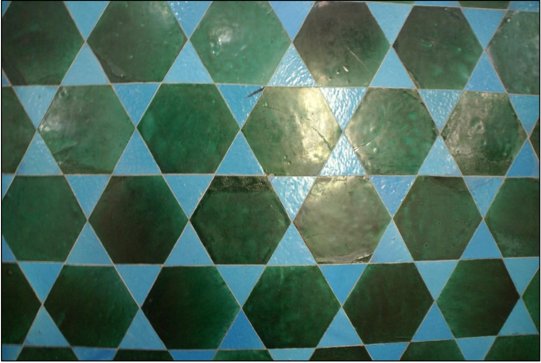
R. 43: Bursa Muradiye Camii Ana Eyvan Dođu Duvarı Çinilerinden Bir Detay
