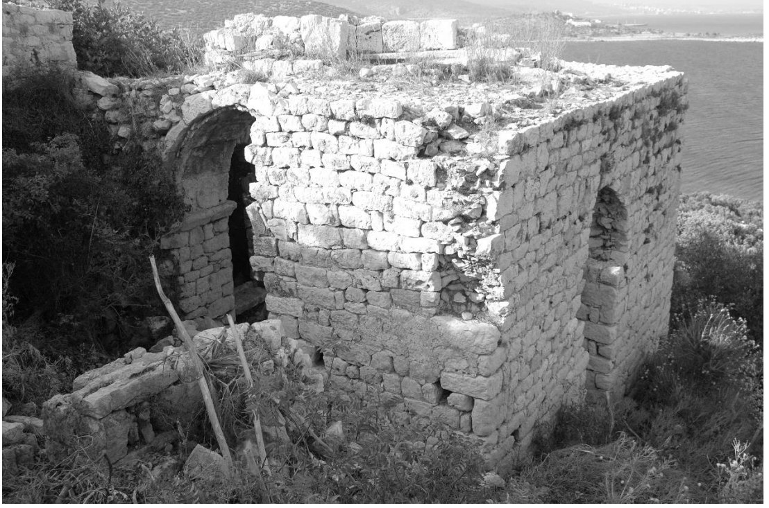
Şekil C. 45. Narteksin doğu duvarına köşeden bakış. Duvarın güney köşesinde bozulmuş kemer izi görülmektedir, 2010 (©BOGA Arşivi).
