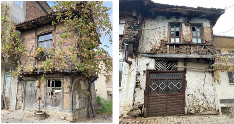
Şekil 5.8: Dış etkenler ve terk edilmeden kaynaklı bozulmaların gözlemlendiği cephe örnekleri (C. Ş. Ekmen Arşivi,2023).
