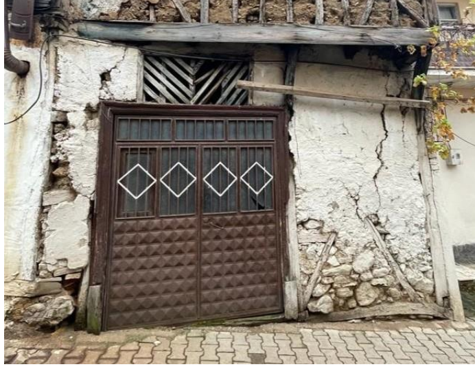
Şekil 5.15: Kerpiç sıvada zamanla gözlemlenen aşınma, kopma ve kabuklanma bozulmaları (C. Ş. Ekmen Arşivi,2023).
