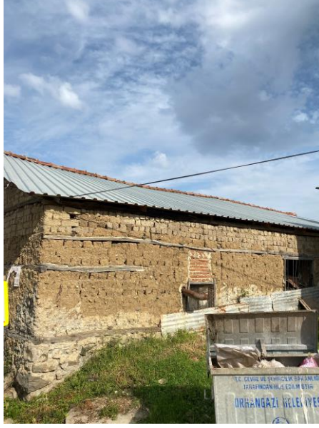
Şekil 5.7: Çatı örtüsünün özgün olmayan teknik ve malzeme ile değiştirilmesi (C. Ş. Ekmen Arşivi,2023).
