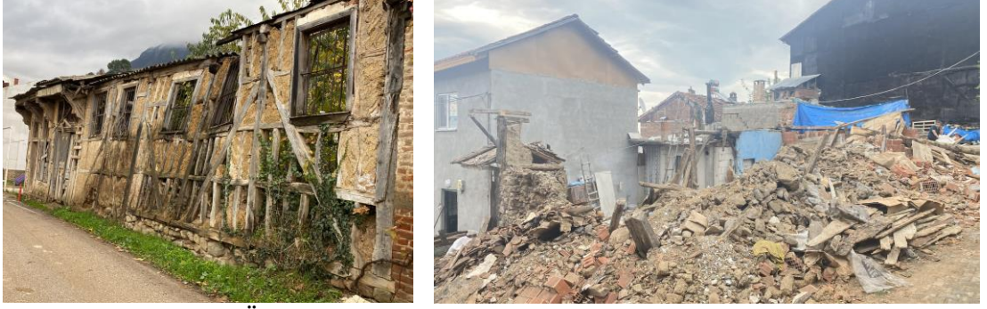
Şekil 5.9: Üst örtünün yıkılmasıyla harabe haline gelen yapı (solda), dış etkenler sebebiyle yıkılan yapı (sağda) (C. Ş. Ekmen Arşivi,2023).
