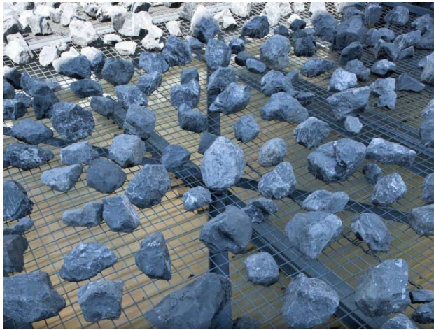
Şekil 195. Koruma Çatısı Üzerindeki Taşlar (url-83)
