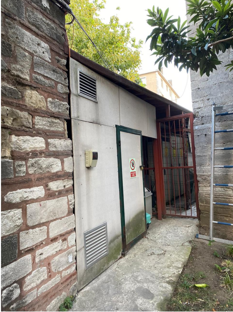
Şekil 131. Vatan Kliniği Girişi Jeneratör Yerleşimi (Ersoy Bıçme, 2023)
