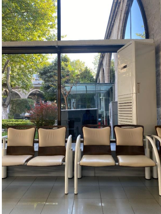
Şekil 139. Vatan Kliniği Eklenen Soğutma Grupları (Ersoy Biçme, 2023)
