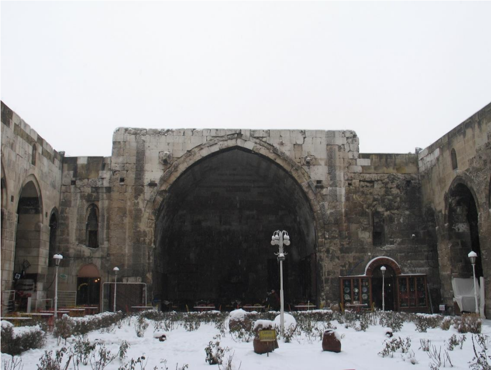
Şekil 17. I. İzzeddin Keykâvus (Şifahiye) Darüşşifası Restorasyon Öncesi Fotoğrafları (Vakıflar Genel Müdürlüğü Dijital Arşivi)
