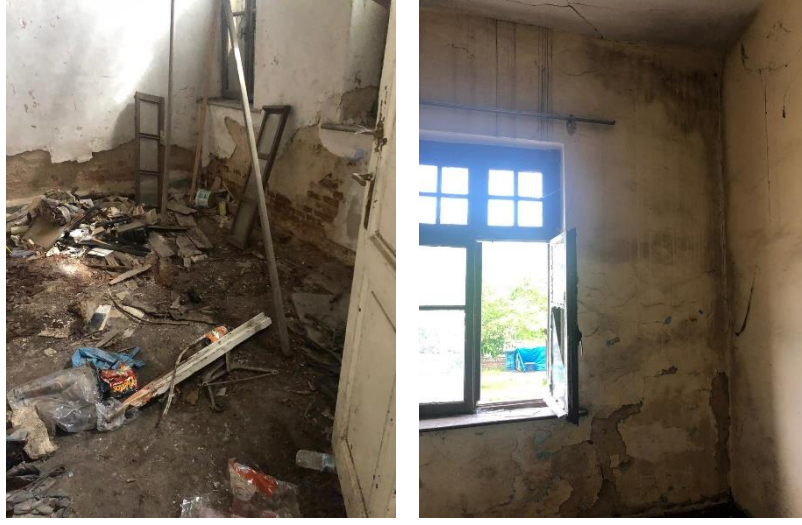
Şekil 4.9-10. Z04 ve Z07 numaralı odalarının duvarlarında gözlemlenen sıva bozulmaları
