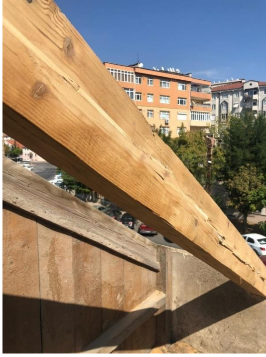
Şekil 6.3. Ahşap dolgusu yapılan taşıyıcılardaki çatlaklar görülmektedir.
