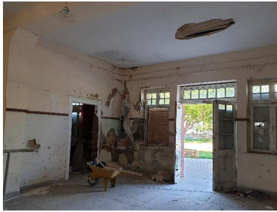
Şekil 6.39. Z01 numaralı odanın tavan ve duvarlarıdaki sıva kabarmaları görülmektedir.
