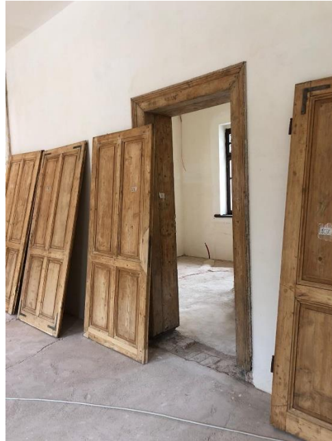
Şekil 6.149. Kırklareli Gar Binası birinci kat iç kapılarının tamamlanan ahşap konservasyon uygulaması görülmektedir.
