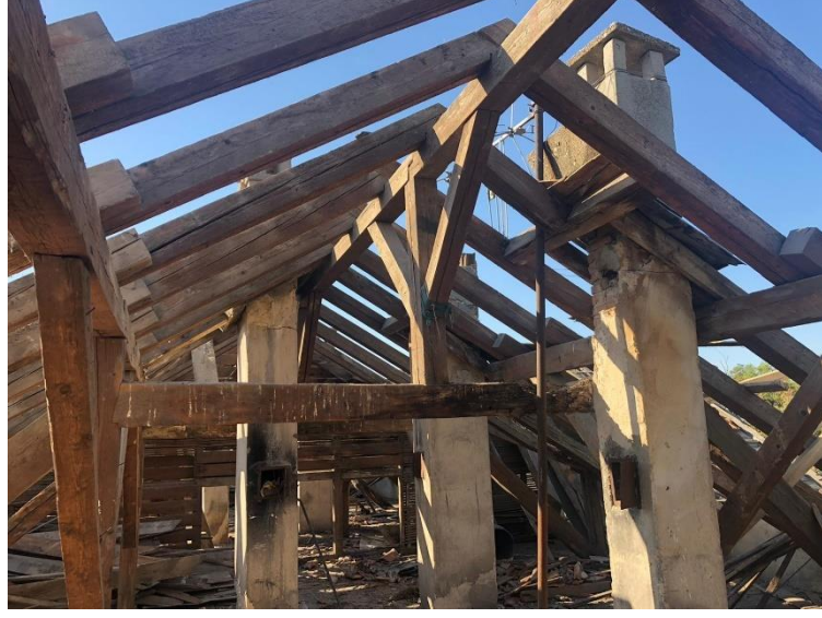
Şekil 4.2. Yapının çatı taşıyıcı aşıklarında ayrılma ve çatlaklar görülmektedir.
