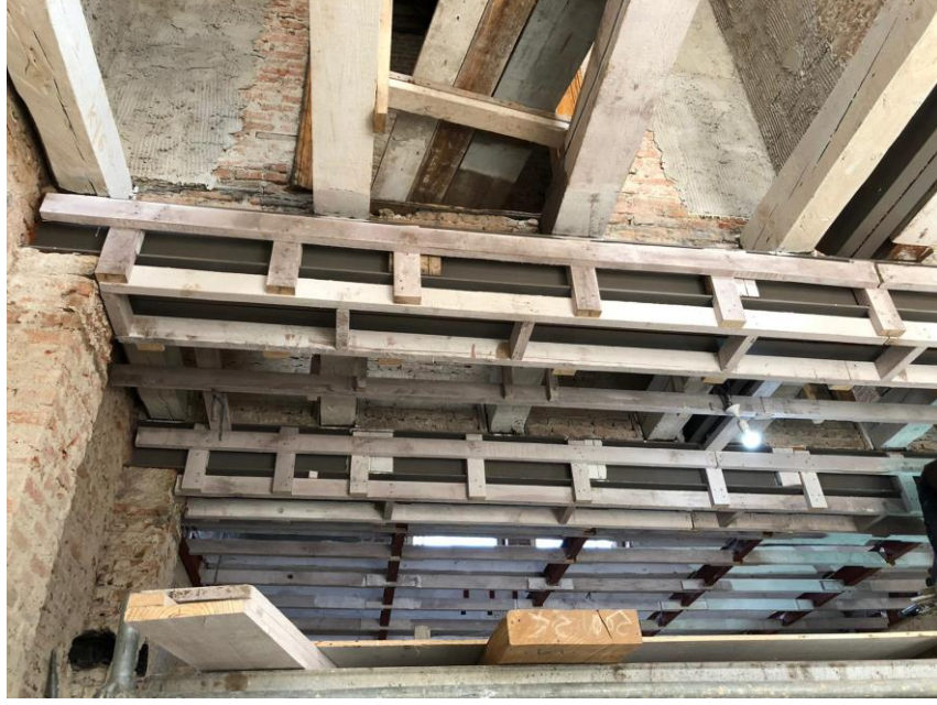
Şekil 6.15. Zemin kat tavanındaki (Z01 giriş) ana taşıyıcı kirişlere takviye yapılan ahşap karkaslar görülmektedir.
