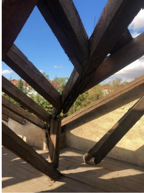
Şekil .1. Yapının çatı taşıyıcılarında çürüme ve çatlaklar görülmektedir.
