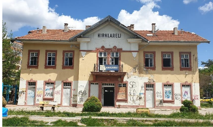
Şekil 6.160. Yapının Kuzey cephesinde kayıp olan kapı doğramaları ve yapıdaki muhdes ekler görülmektedir.
