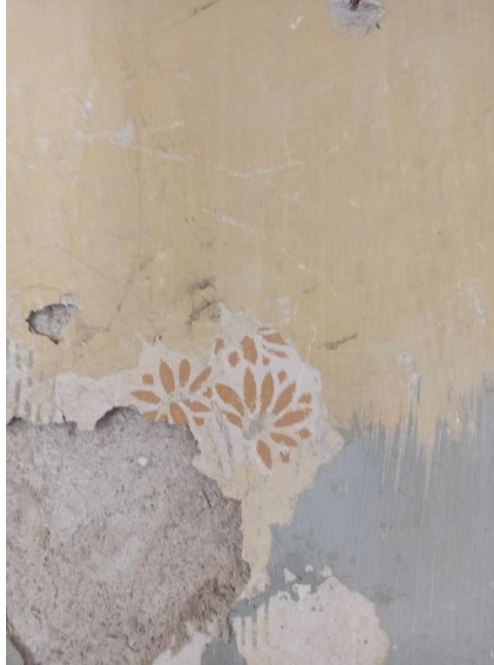
Şekil 6.37. Yapıda kalem işi olduğuna dair şüphe uyandıran Z02 numaralı odanın duvarındaki stencil baskı çiçekler görülmektedir.
