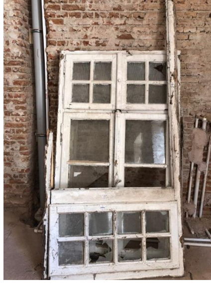
Şekil 6.166. Yapının Güney cephesiden sökülen kullanılamaz hale gelmiş çift kanatlı pencere görülmektedir.
