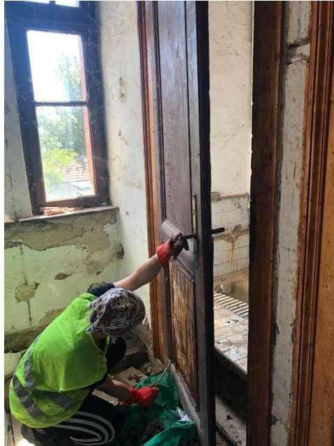
Şekil 6.145. Kırklareli Gar Binası 101 numaralı tuvaletin kapı kasasında mekanik yöntemler ile yapılan ahşap raspası görülmektedir.
