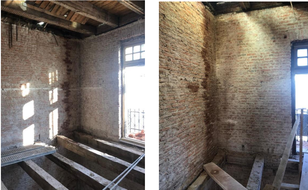
Şekil 6.28. Birinci katta bulunan 112 ve 114 numaralı odaların bölücü duvarlarında yapılan tuğla dikişler görülmektedir.
