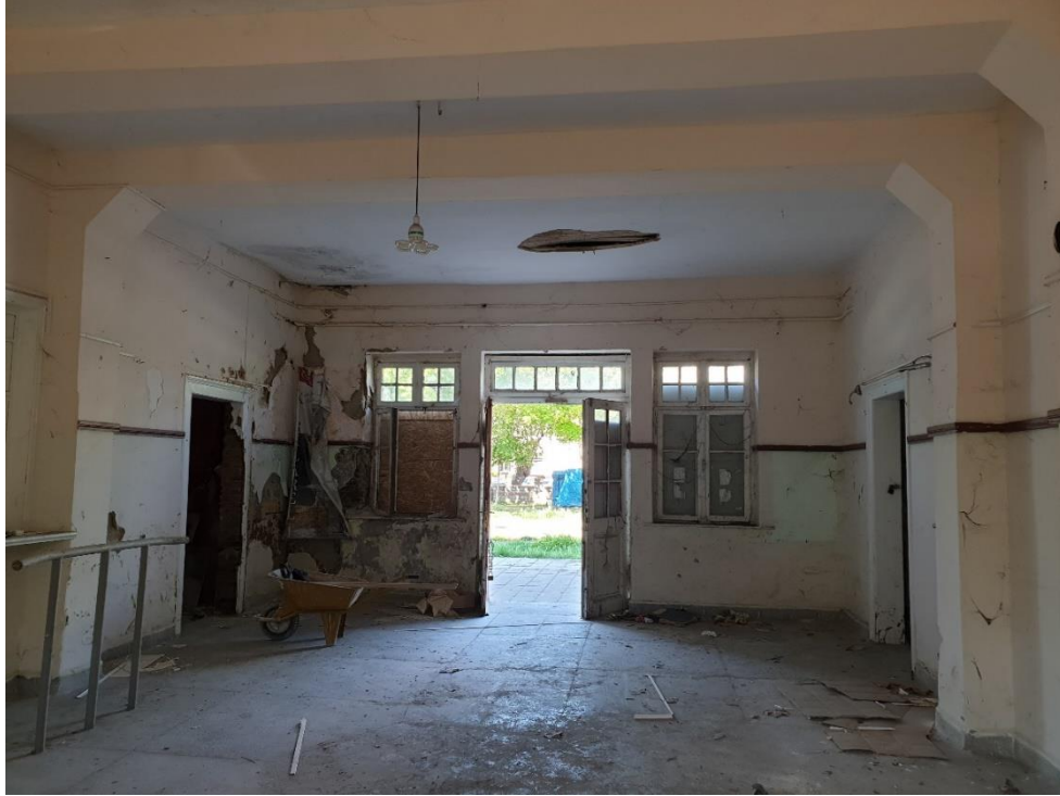
Şekil 4.8. Z01 numaralı giriş salonunun duvar ve tavanında gözlemlenen sıva bozulmaları
