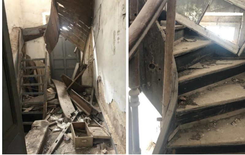
Şekil 4.5-6. Zemin kattan lojman dairesine çıkan yanmış merdivenin kalan ahşap parçaları.
