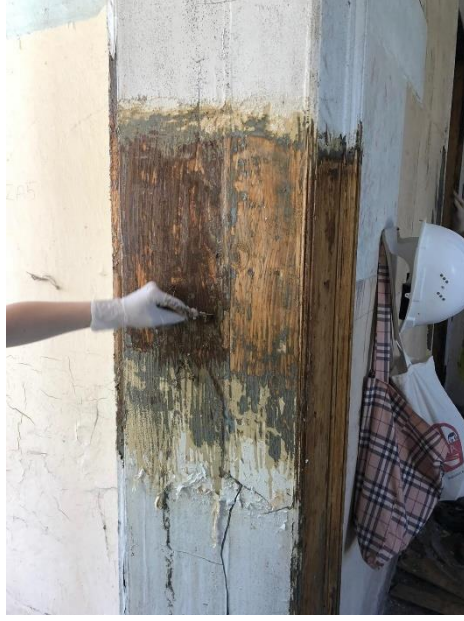
Şekil 6.144. Kırklareli Gar Binası Z02 numaralı odanın kapı kasasında bisturi ile yapılan ahşap raspası görülmektedir.
