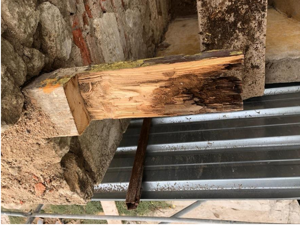
Şekil 5.1. Kırklareli kagir tuvalet yapısı- Çürüyen çatı kirişi
