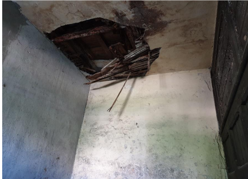
Şekil 4.3. Z07 numaralı odanın tavanındaki çökme görülmektedir.
