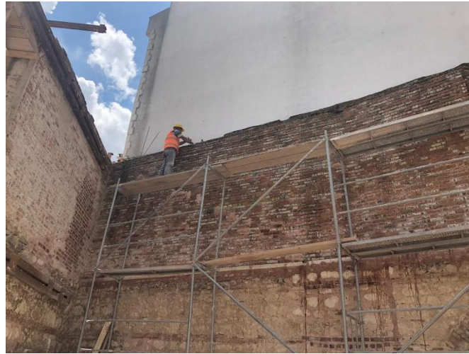
Şekil .3. Kırklareli Kaptan'ın Evi- Tuğla duvarlardaki çözüne ve uygulanan mekanik temizlik görülmektedir.
