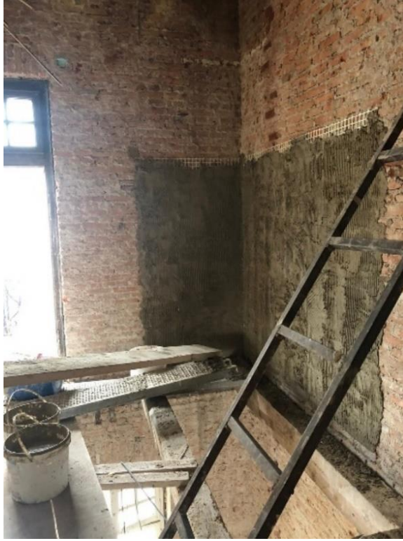
Şekil 6.33. 114 numaralı odanın duvar birleşim yerinde uygulanan güçlendirme uygulaması görülmektedir.
