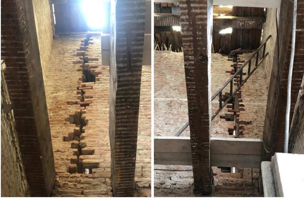
Şekil .27. Birinci katta bulunan 105 ve 108 numaralı odaların bölücü duvarlarında açılan tuğla çürütmeler görülmektedir.
