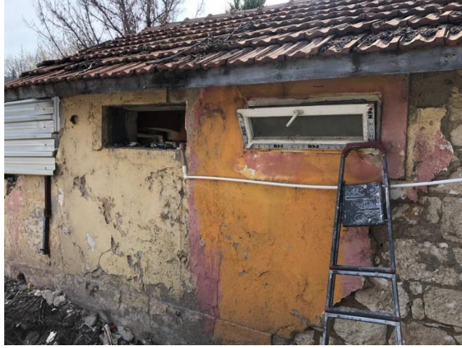
Şekil 5.7. Kırklareli kagir tuvalet yapısı- Dış duvarlardaki sıvanın müdahale öncesi durumu görülmektedir.
