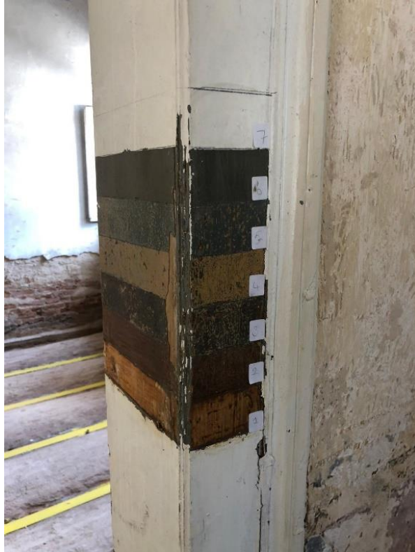
Şekil .143. Kırklareli Gar Binası Z05 numaralı odanın kapı kasasında yapılan ahşap boya katmanları görülmektedir.
