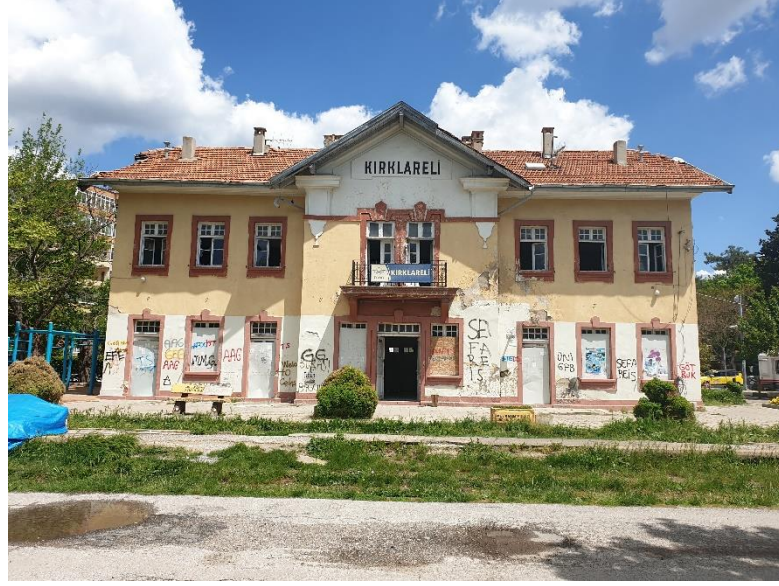
Şekil 3.16. Yapının Batı cephesindeki muhdes ekler görülmektedir.
