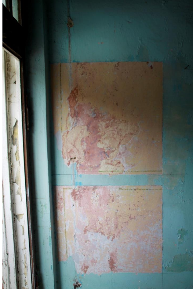
Şekil 6.57. 107 numaralı odanın batı duvarının köşesinde çıkan renk katmanları görülmektedir.
