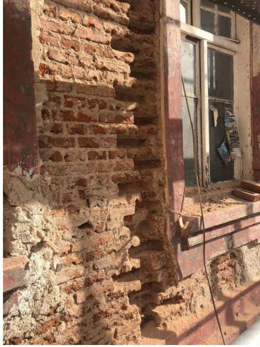
Şekil 6.30. Yapı Doğu cephesinde açılan tuğla çürütmeler görülmektedir.
