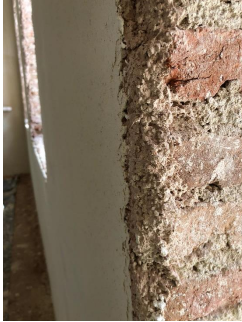
Şekil 6.87. Yapının Z02 numaralı odasındaki duvarın katmanları görülmektedir. (ateş tuğlası-horasan esaslı kaba sıva-nefaset sıvası)
