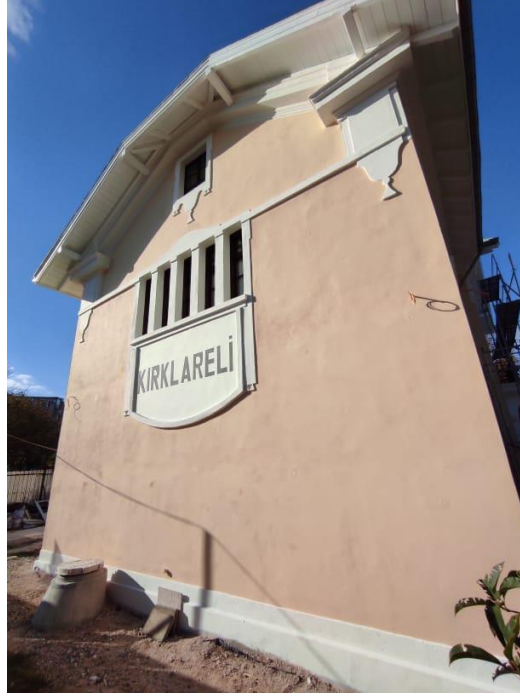
Şekil 6.168. Yapının Doğu cephesinde yeniden imalatı yapıp montajı tamamlanan tek kanatlı birinci kat ve çift kanatlı çatı katı penceresi görülmektedir.
