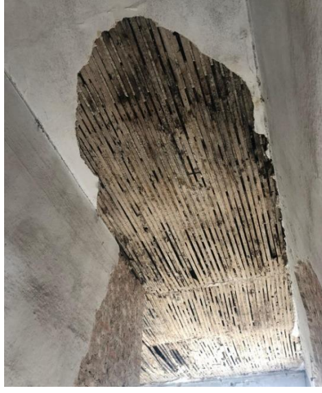
Şekil 4.4. Yapının dökülen tavan sıvasının altında çürüyen bağdadi döşeme görülmektedir.
