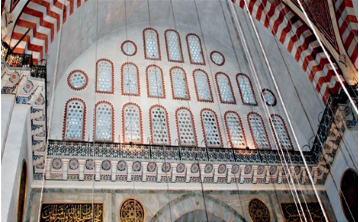
Fotoğraf 38 S.C. Üst örtü sistemi galerisi demir korkuluğu ve konsol yüzeylerinde kalemişi bezeme. (Mevcut durum)
