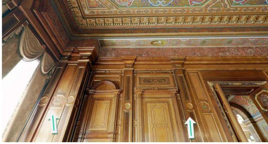
Şekil 72: 21 No'lu Oda'nın duvarında bulunan panolar
