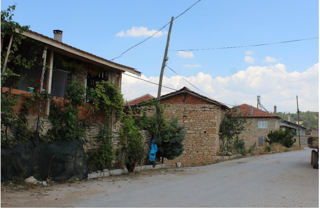
Şekil 5.25 Yüzeysel onarım gerektiren yapılar örneği (2019)
