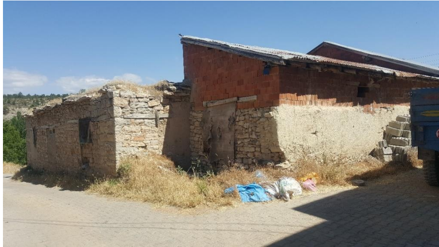
Şekil 6.2 Emen Köyü tuğla ile yapılan niteliksiz onarım örneği (2020)
