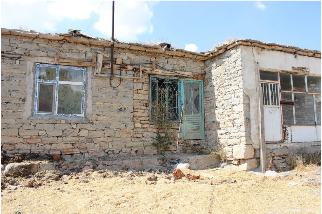
Şekil 5.26 Esaslı onarım gerektiren yapı örneği (2019)
