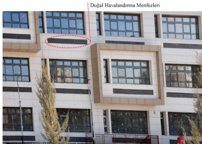
Şekil 4.5. Cezeri Yeşil Teknoloji TEML cephesindeki ısı geri kazanımlı doğal havalandırma menfezleri.
