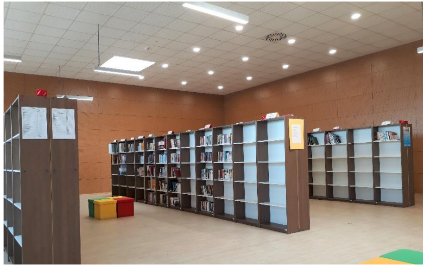
Şekil 4.21. Cezeri Yeşil Teknoloji TEML kütüphanesi aydınlatma armatürlerinin dağılımı (Cezeri Yeşil Teknoloji TEML Fotoğraf Arşivi).
