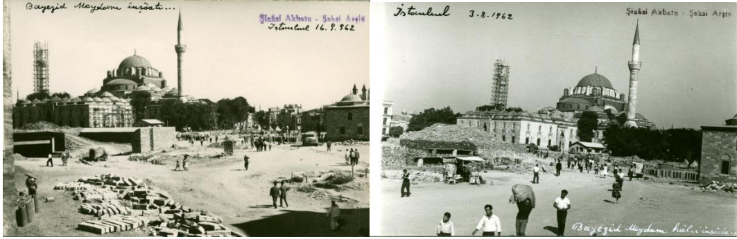
Şekil 2. 25. İstanbul II. Beyazıt Camii 1962 onarımı minare ve cephede görülen iskele detayı (Şinasi Akbulut Arşivi, Atatürk Kitaplığı)
