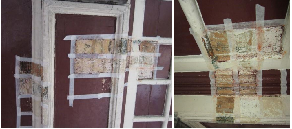
Fotoğraf 4. 24. Özgün ahşap kapılarda boya araştırması yapılması (A.ASLAN)
