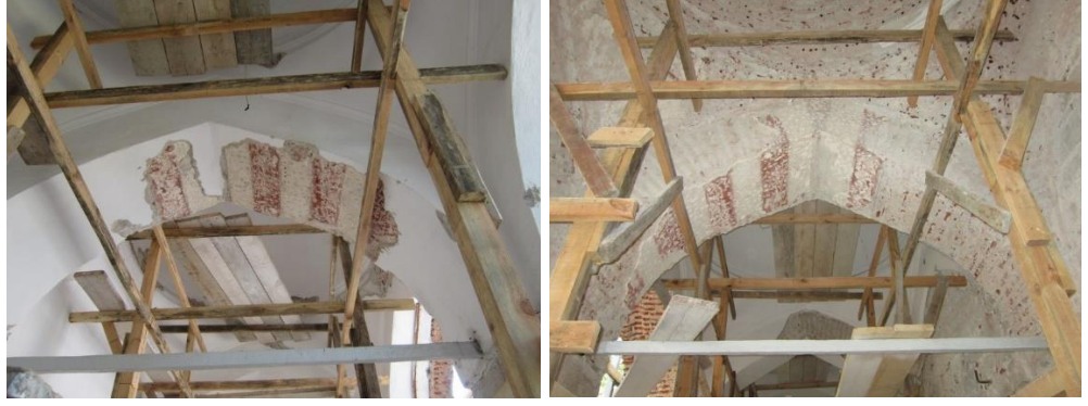
Fotoğraf 4. 31. Revaklarda yapılan itinalı çimento raspası sonrası ortaya çıkan bazı kemerlerdeki kırmızı-beyaz taş taklidi bezeme ve paslanmış siva çivileri (A.ASLAN)
