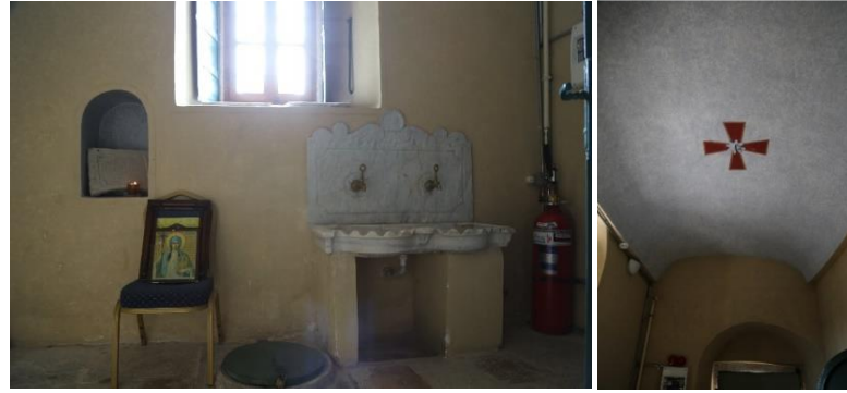
Şekil 5. 43- Ayios Basilios Ayazması kuyusu ve iki musluklu yalıklı çeşme ile tavanında görülen kalemişi uygulaması,2020
