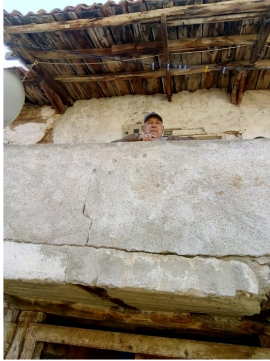
Şekil 4.2: K3'ün Eski Konut Yapısında Oluşan Çatlaklar (Yapı Sahibi Tarafından Çekilmiştir.)
