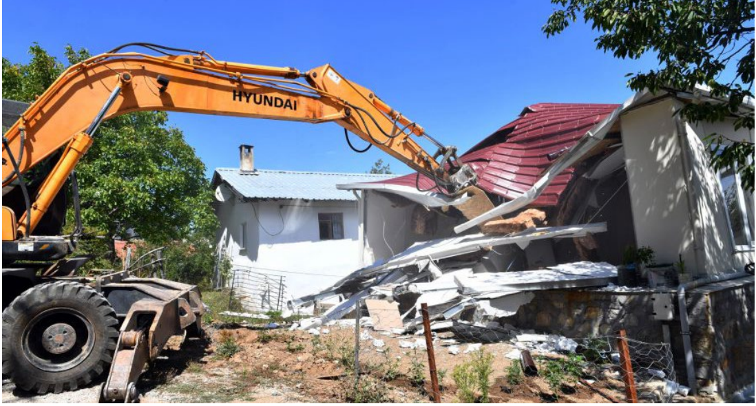
Şekil 4.12: Kaçak Yapılan Yapının Belediye Tarafından Yıkılması (Url-7)
