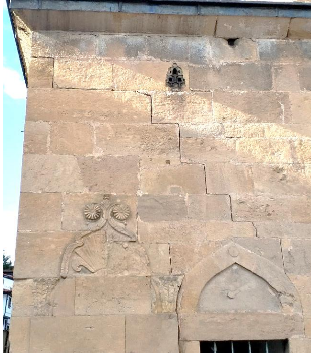
Resim 6.16 : İbn-i Neccar Camii'nin güney cephesinde oluşan çatlak (Ağustos 2019)
