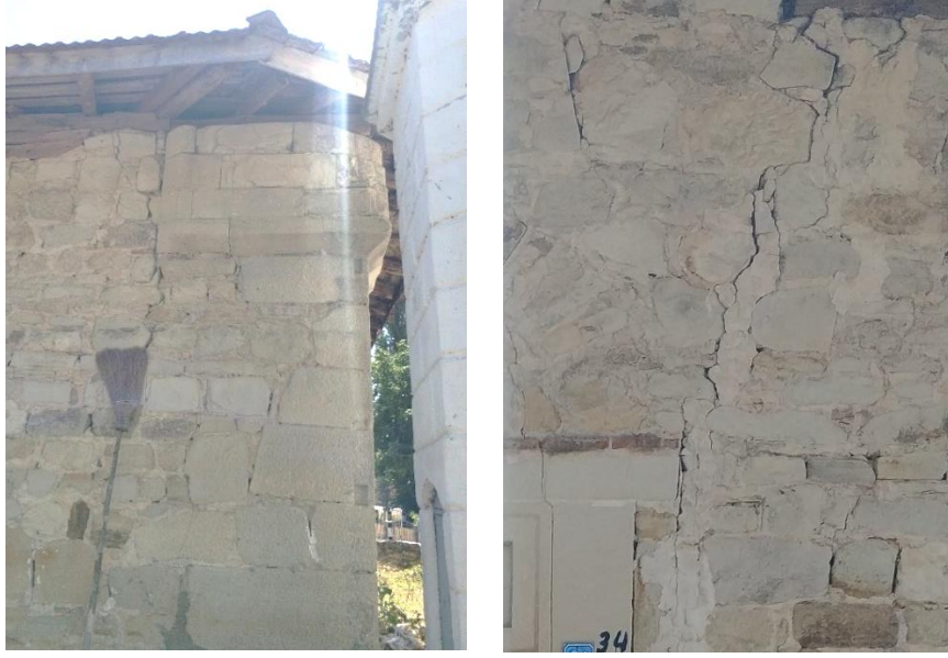
Resim 6.10 : Saray Camii'nin duvarlarındaki çatlaklar (Ağustos 2019)
