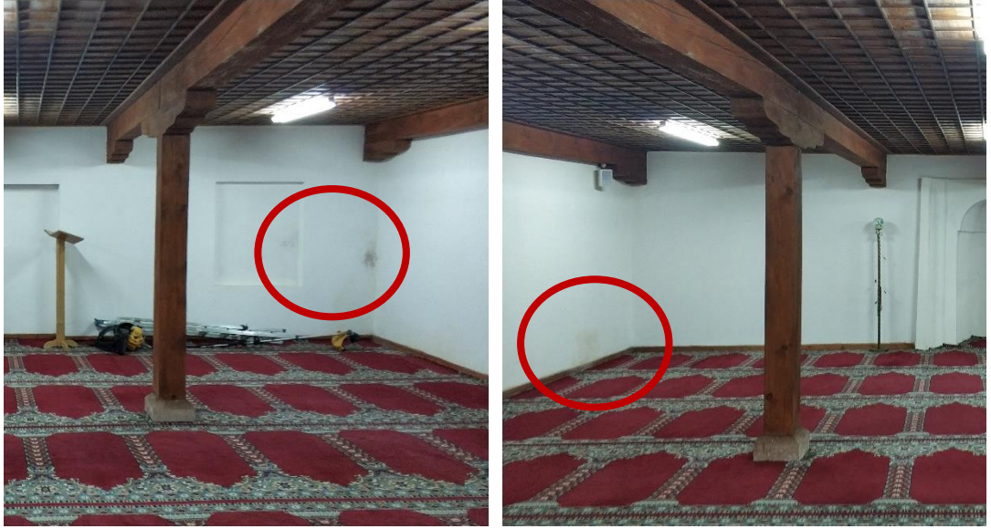
Resim 6.8 : Kötürüm Beyazıd Camii'nin duvarlarındaki rutubet oluşumları (Ağustos 2019)
