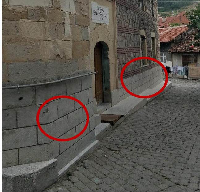
Resim 6.6 : Aktekke İbrahim Bey Camii'nin duvarında yer kotunun yükselmesinden oluşan bozulmaların sonucu yapılan müdahaleler (Ağustos 2019)
