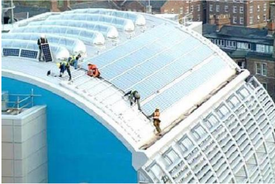
Resim 5.53: Çatıda kullanılan fotovoltaiik panellerden görünüm (Url-56).
