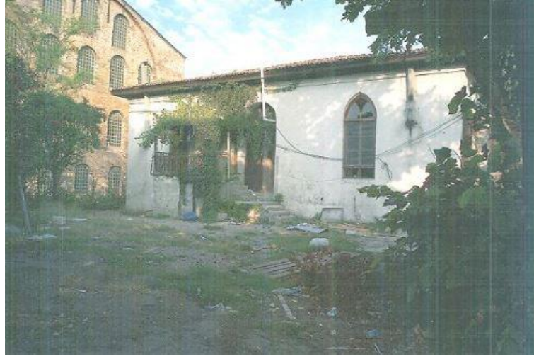
Görsel 3.77: Karakolhane batı cephesi, 2008 onarımı öncesi, İRAMA
