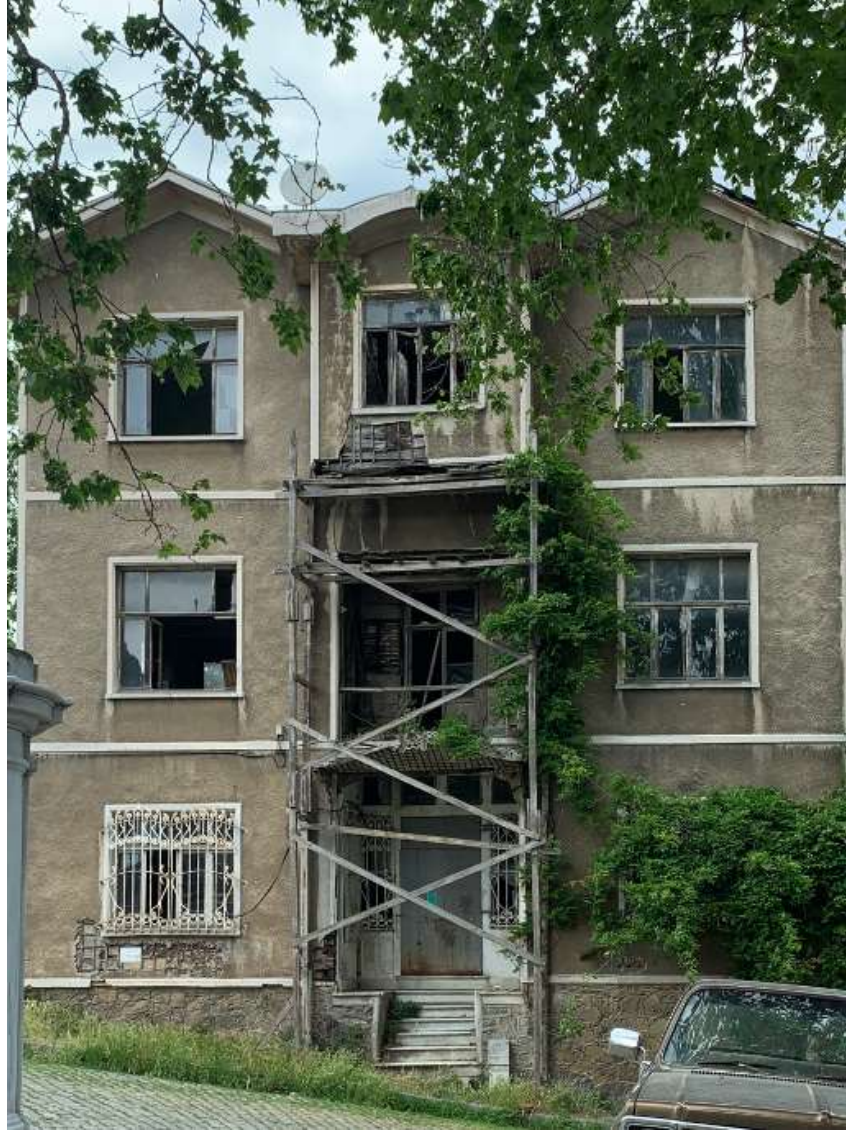
Şekil 1.108 122 ada 19 parselde bulunan, strüktürel durumu zayıflamış ahşap karkas yapı
