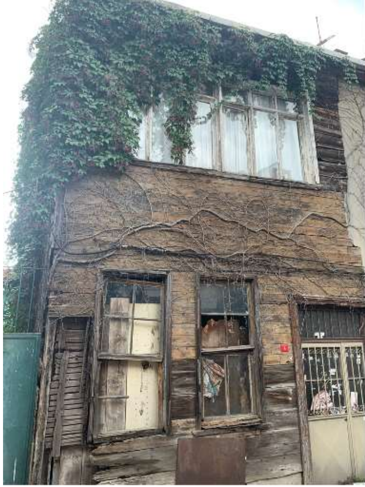
Şekil 1.106 Büyük oranda zarar görmüş yapı
