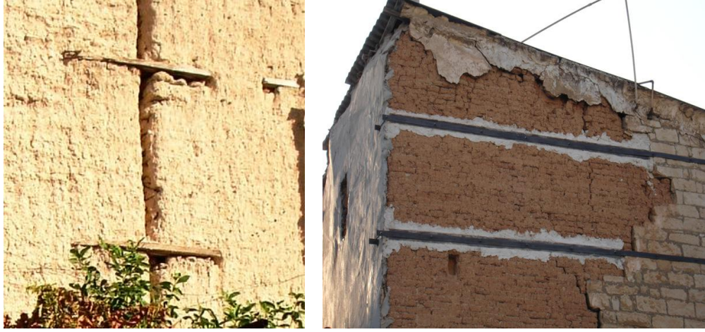
Resim 5.9, 5.10: Dikey çatlakı onarmak için yatay ahşap kiriş kullanımı (solda). Yine çatlamayı önlemek için kerpiç yapıya monte edilmiş çelik kayışlar (sağda). (Rogiros Illampas, 2009, Ioannis Ioannou, Dimos C. Charmpis)
