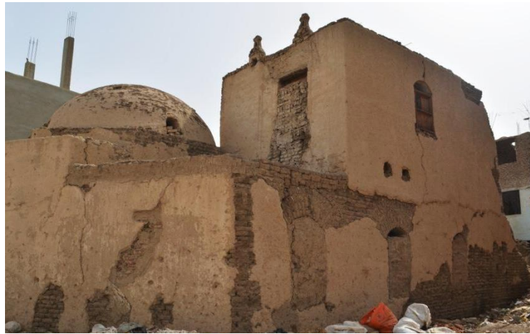
Resim 5.4: Duvar Şişmesi ve Çökmesi, El Kurna - Luksor, Mısır, (Rasha ELBORGY)
