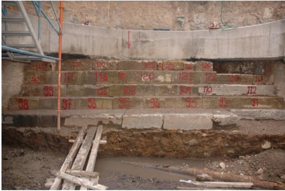
Resim 3. 17- Numaralandırılarak sökülmesi, Marmaray projesi, Sirkeci istasyonu Roma dönemi duvar kalıntısı, (Somun İnşaat,2012)
